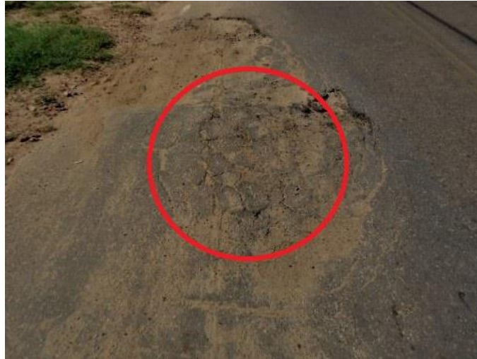
Figura 3. Trinca Couro de Jacaré
