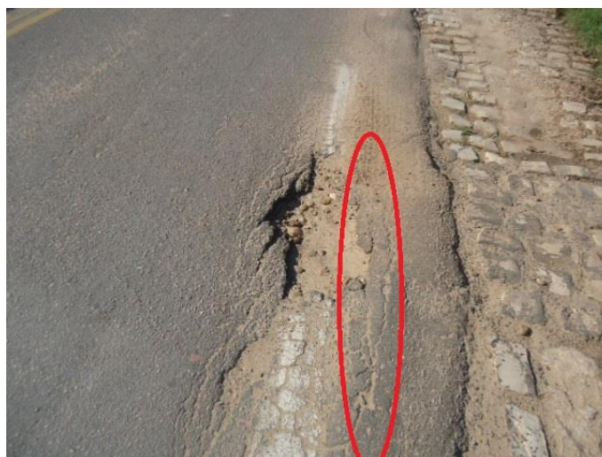
Figura 2. Trinca Longitudinal curta com panela
