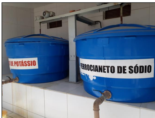
Figura 14 - Área de diluição e preparo dos aditivos.
