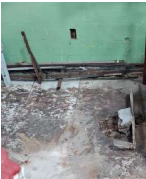
Figura 27 – Manchas de corrosão no Boxe 66
