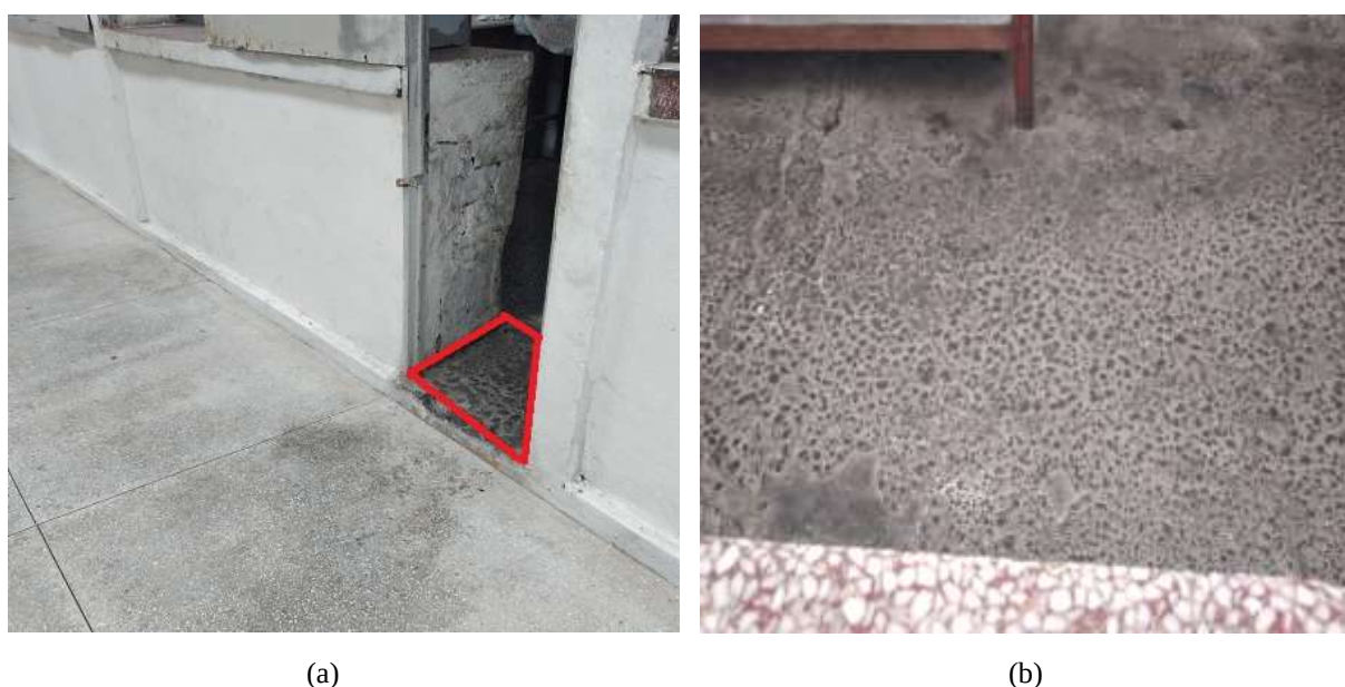
Figura 26 – Erosão no Boxe 18; (a) Ocorrência de erosão no chão do Boxe; (b) Ampliação da erosão
