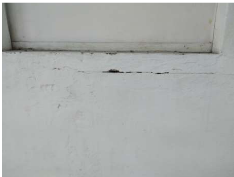
Figura 25 – Fissura presente embaixo da janela do Boxe 60
