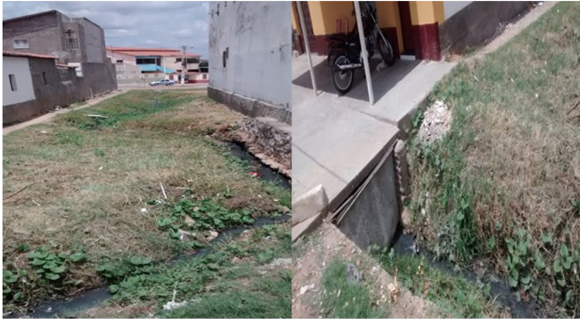
Figura 9 - Esgoto a céu aberto em terreno baldio no São Benedito
