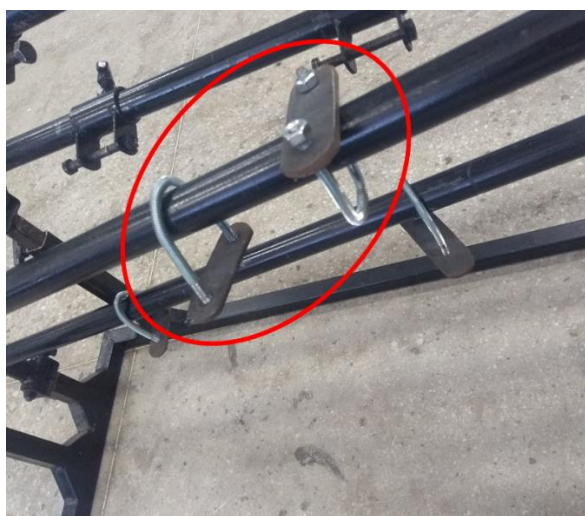
Figura 41 – Detalhe das abraçadeiras responsáveis pelo travamento das bandejas.
