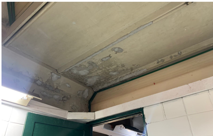
Figura 19: Infiltração no teto.
