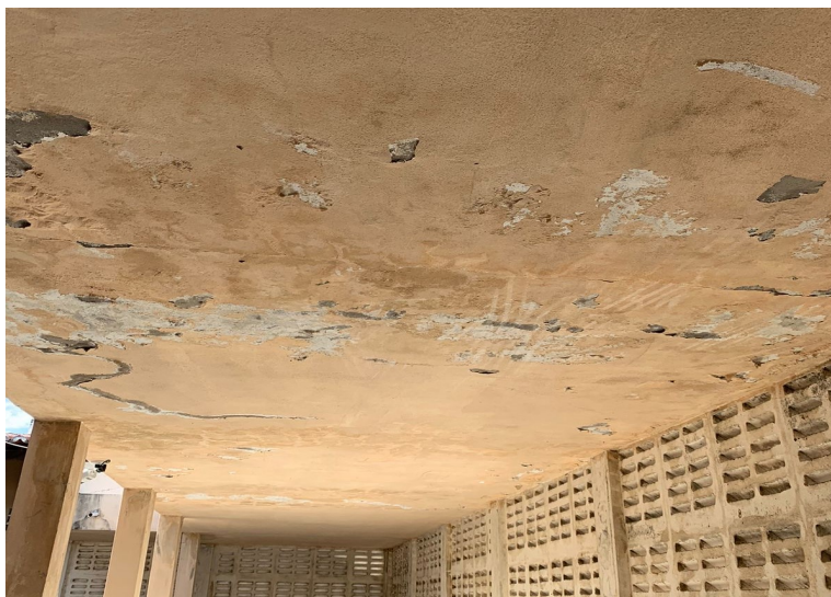
Figura 11: Deslocamento de pintura e revestimento argamassado no teto
