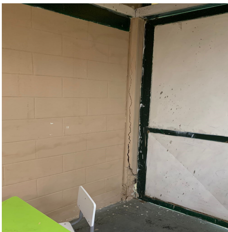
Figura 25: Rachaduras que se estendem do piso até a alvenaria.
