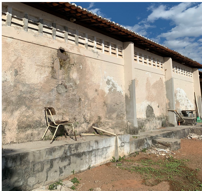
Figura 13: Manchas de infiltração e danos na parede
