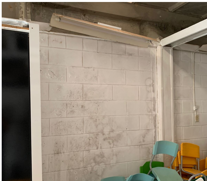
Figura 26: Manchas de mofo.
