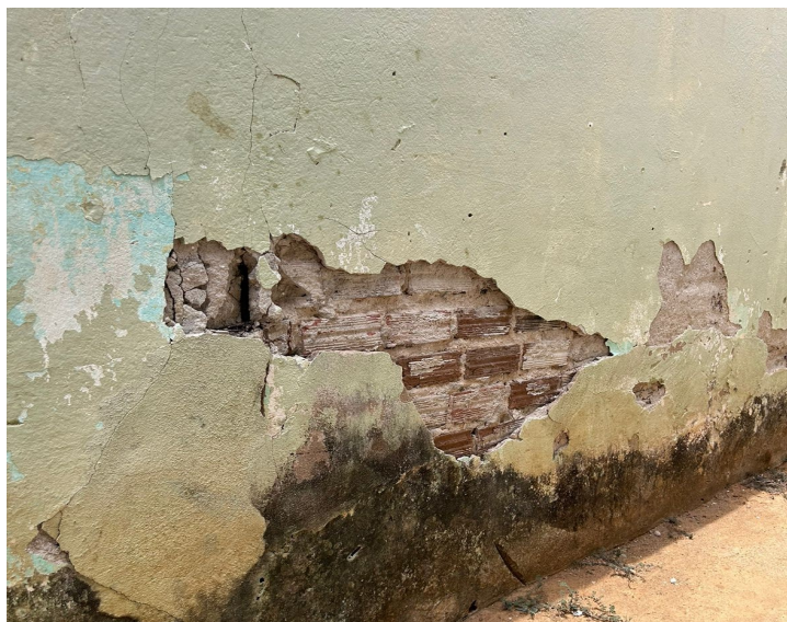
Figura 31: Deslocamento do revestimento argamassado, fissuras e trincas.
