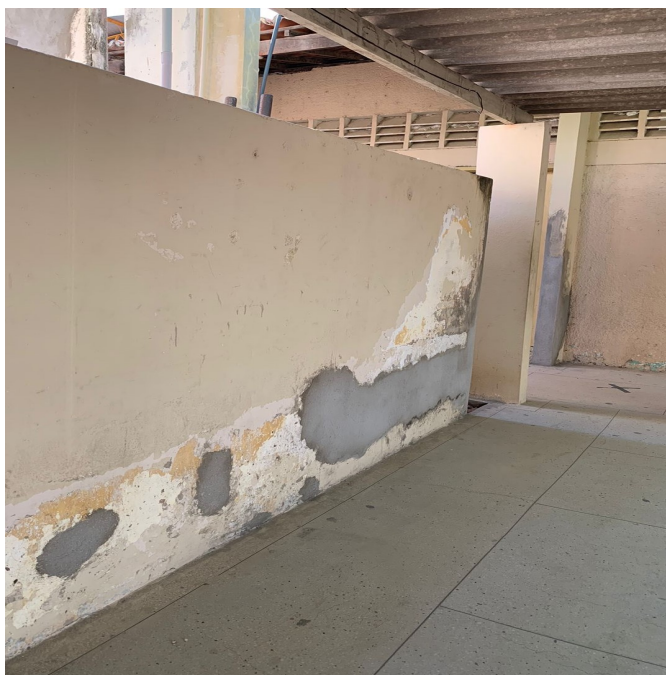
Figura 12: Deslocamento de pintura em parede
