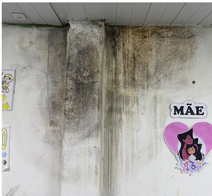
Figura 29: Manchas de infiltração e bolor na parede.
