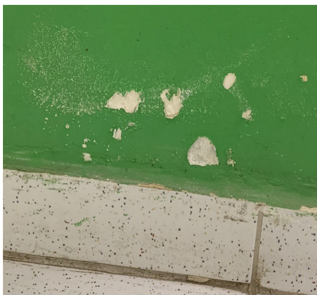
Figura 21: Deslocamento de pintura e argamassado.
