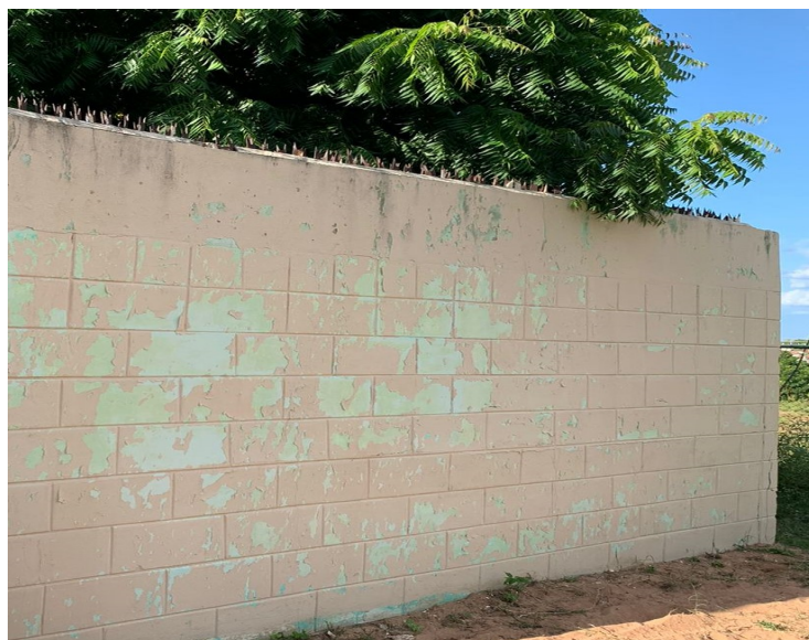
Figura 22: Descascamento da pintura do muro.
