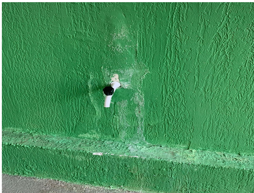
Figura 20: Infiltração em torno de saída de água.
