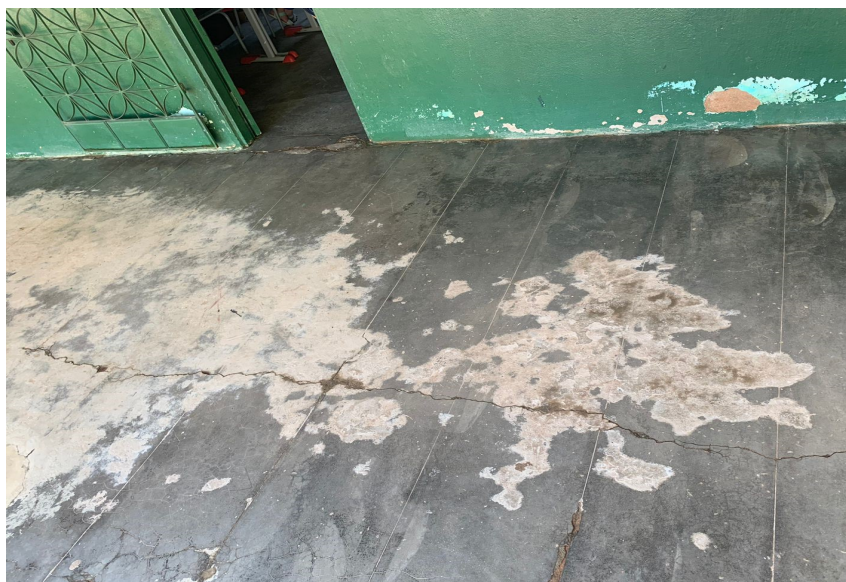
Figura 37: Danos no revestimento do piso.
