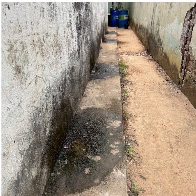
Figura 33: Manchas de infiltração na parede.
