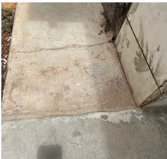
Figura 32: Fissuras horizontais no piso.
