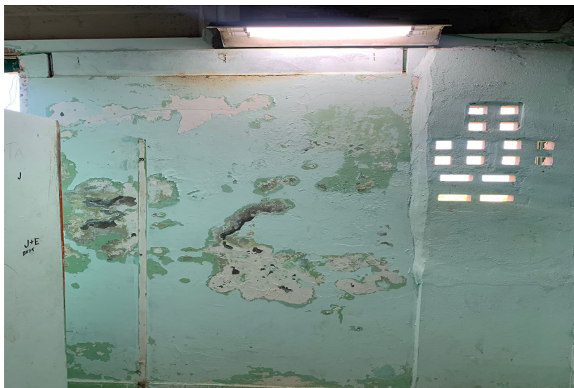
Figura 17: Mancha de infiltração e danos na pintura em banheiro
