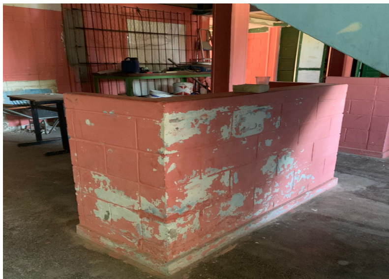
Figura 16: Descascamento de pinturas e argamassados.
