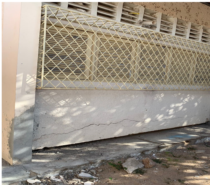
Figura 15: Fissuras e rachaduras na parede
