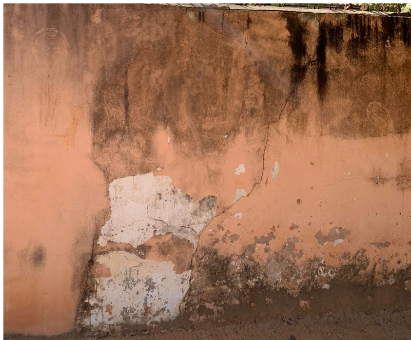
Figura 38: Manchas de mofo, descascamento da pintura e fissuras e trincas na parede.
