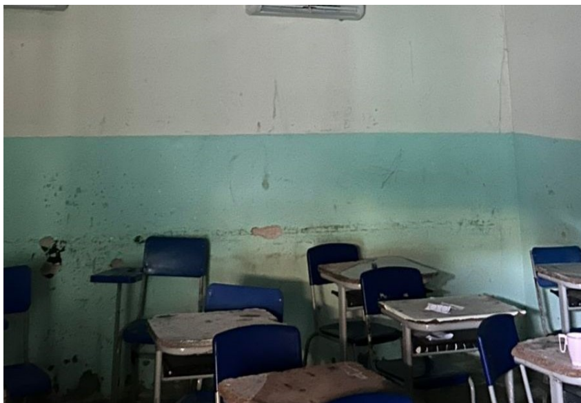
Figura 28: Fissuras e trincas nas paredes.
