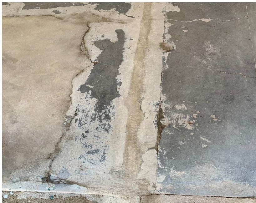
Figura 36: Fissuras e trincas no piso.
