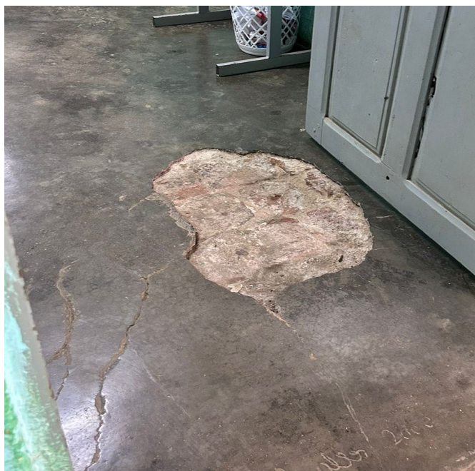
Figura 30: Danos no piso.
