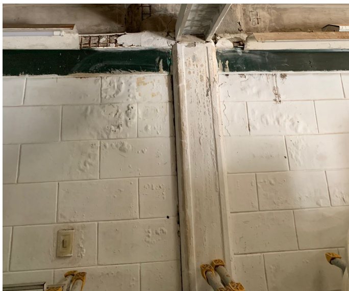
Figura 27: Infiltração na parede.
