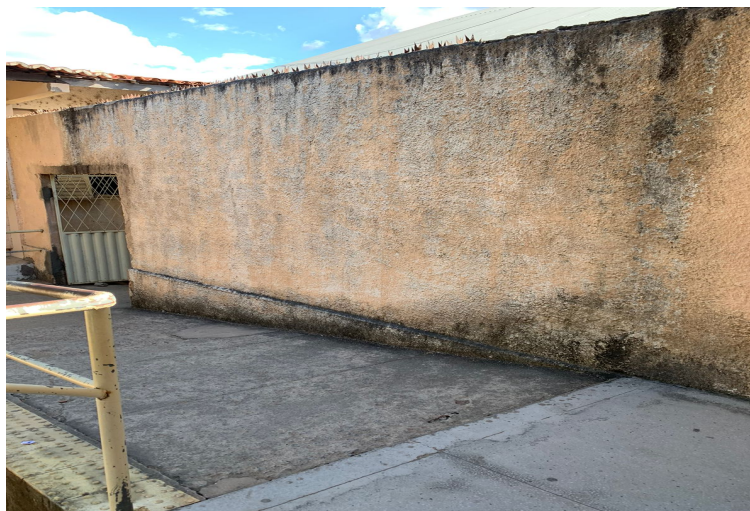
Figura 10: Manchas de infiltração com acúmulo de lodo.
