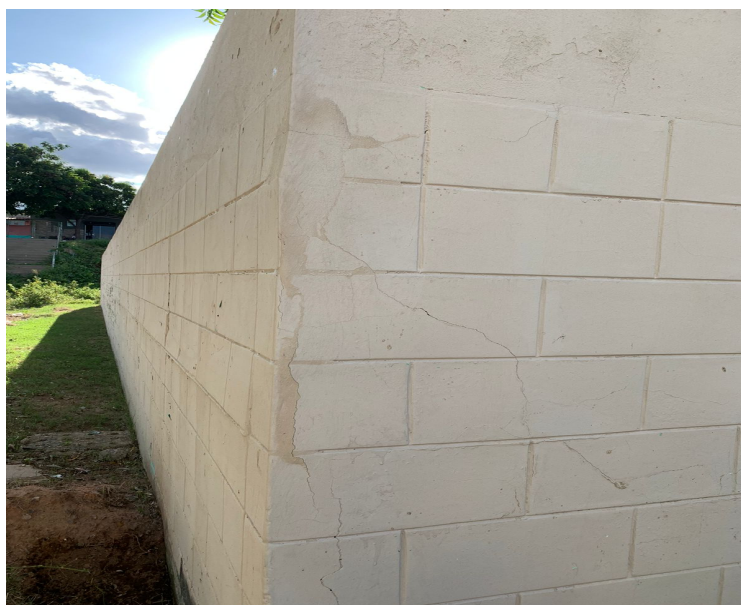
Figura 23: Fissuras na parede do muro.
