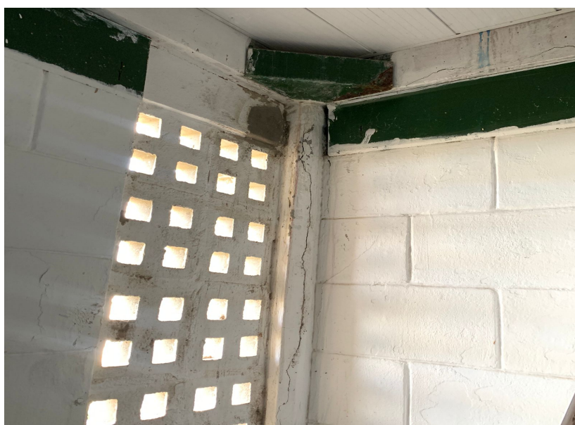
Figura 18: Fissuras e trincas na parede
