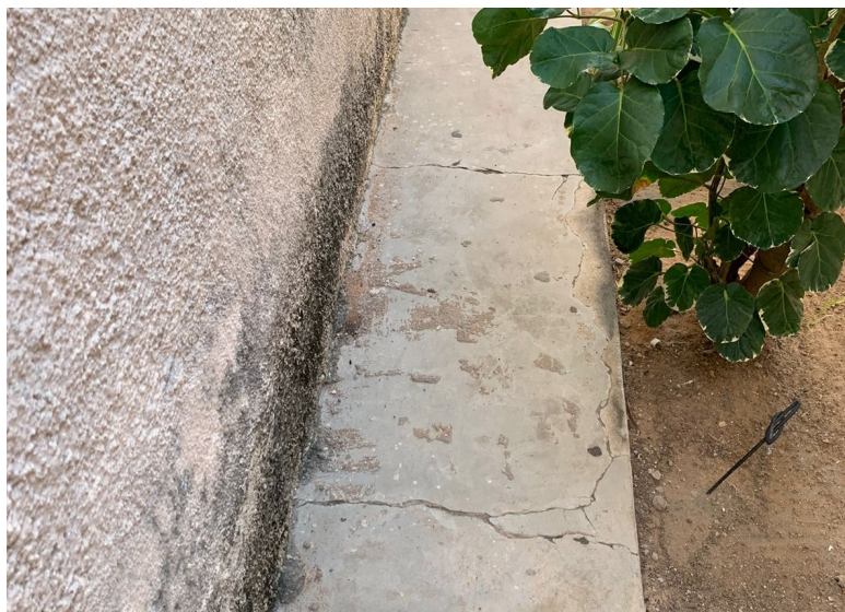
Figura 14: Trincas e rachaduras em piso cimentado
