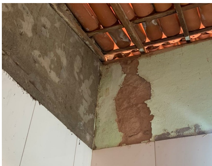
Figura 35: Desplacimento do revestimento argamassado da parede.
