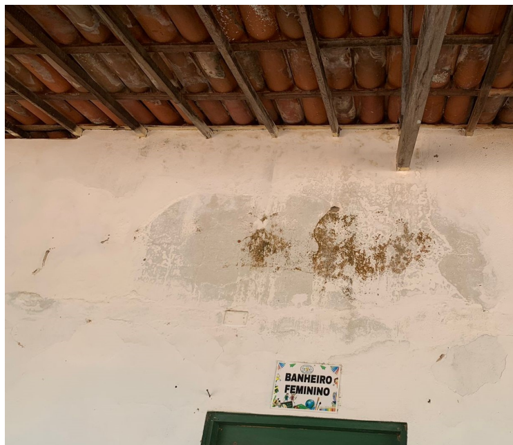
Figura 34: Manchas de infiltração na parede.
