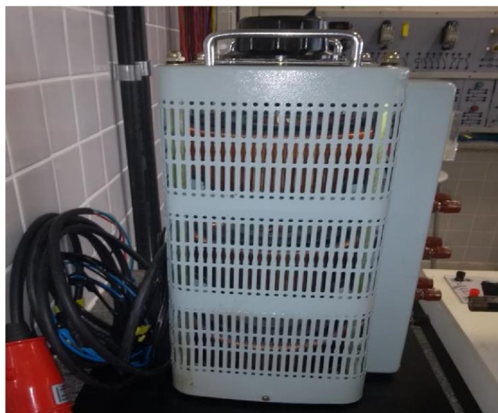
Figura 3: Variador de tensão
