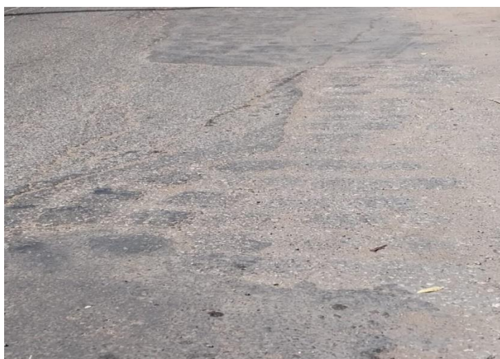
Figura 21 - Trinca do tipo couro de jacaré
