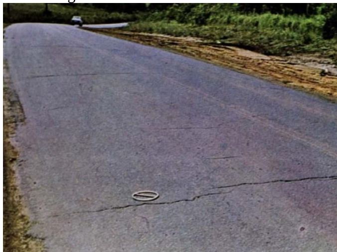
Figura 3 - Trinca Isolada Transversal
