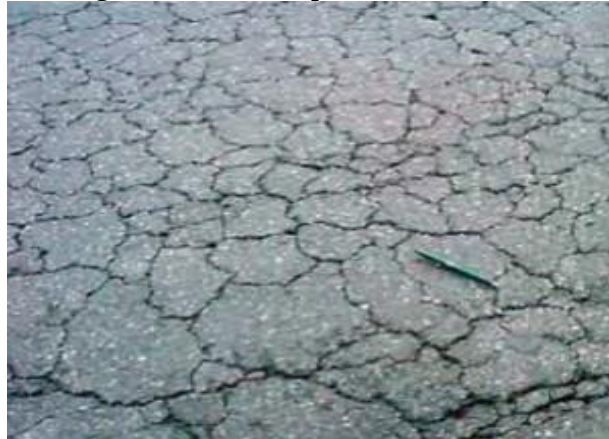
Figura 5 - Trinca tipo Couro de Jacaré
