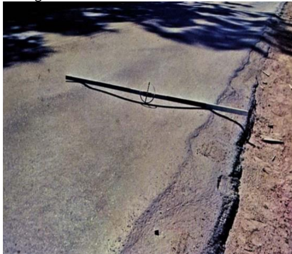
Figura 7 - Afundamento de trilho de roda
