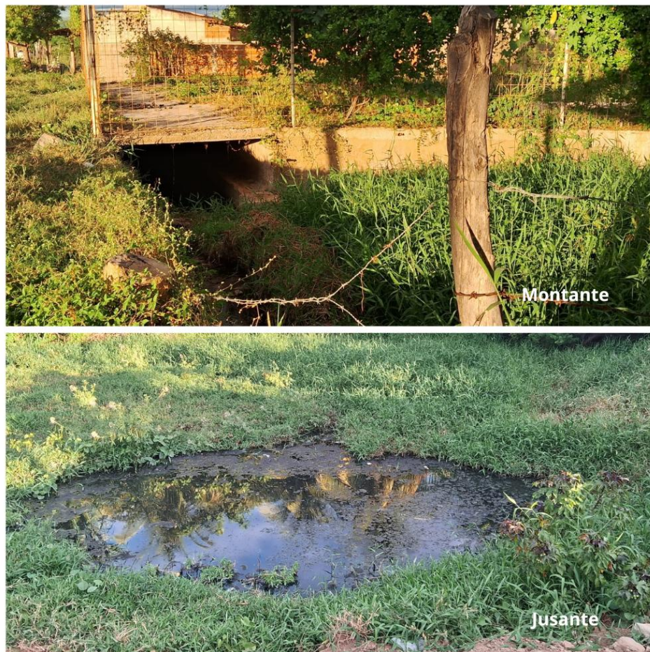
Figura 19 - Galeria com vegetação e acúmulo de esgoto.
