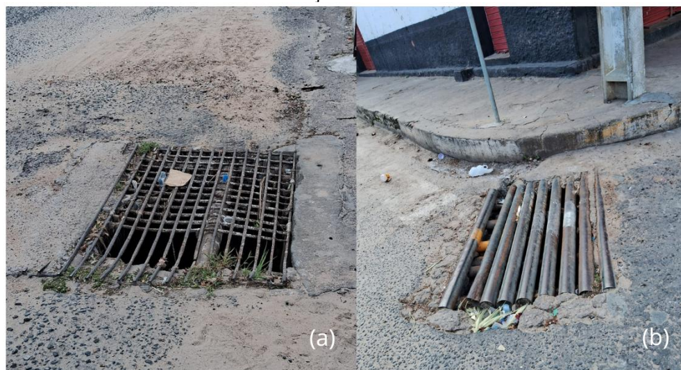
Figura 28 - Bocas de lobo (a) boca de lobo na Avenida Getúlio Vargas e (b) boca de lobo na Avenida Francisco Marçal.
