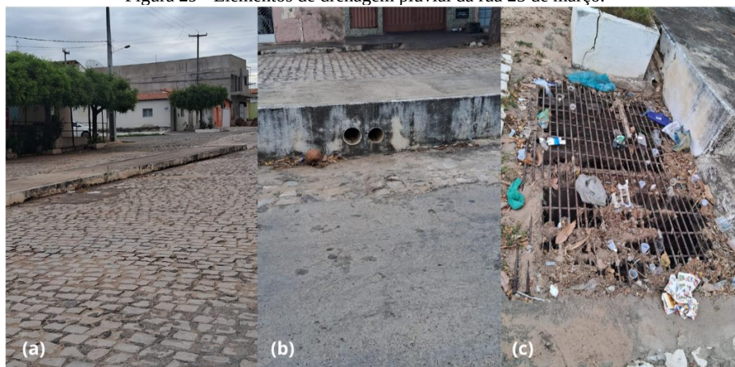
Figura 29 - Elementos de drenagem pluvial da rua 25 de março.
