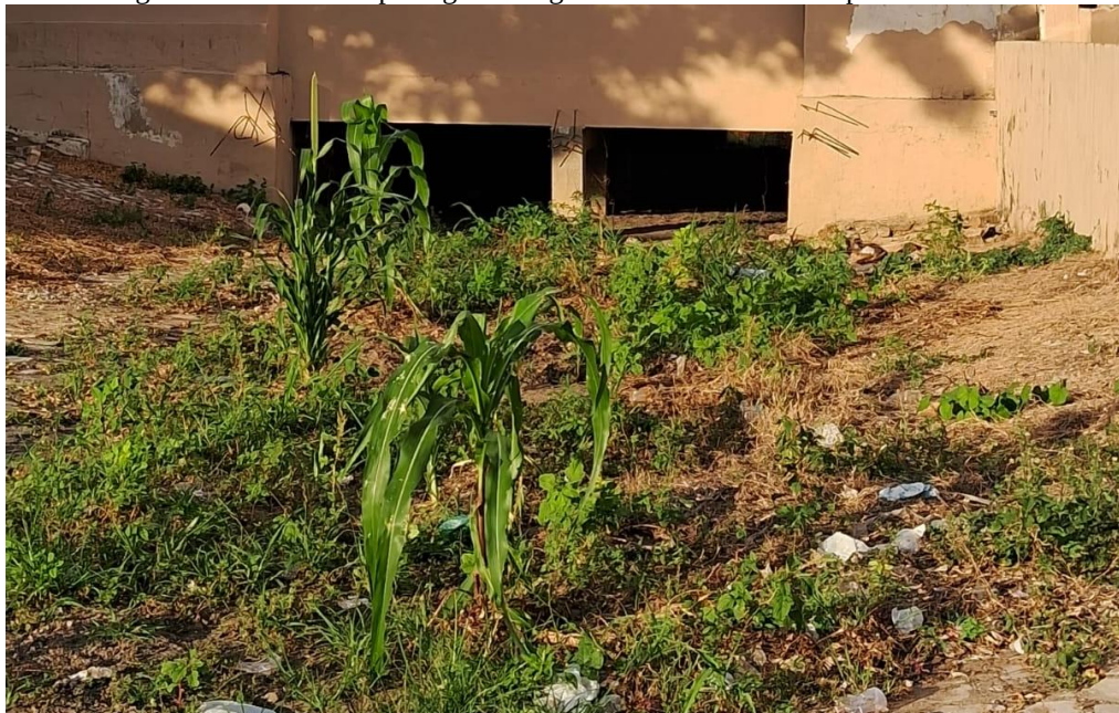
Figura 26 - Galeria de passagem de água com destino ao rio Apodi-Mossoró.
