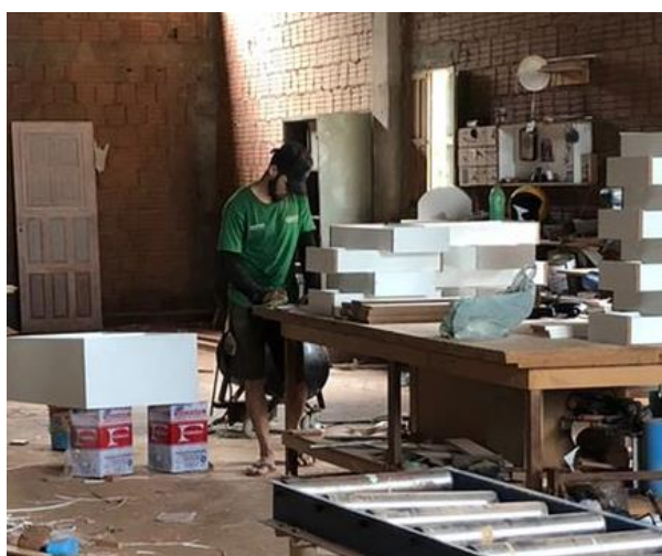
Figura 31 – Ausência de EPIs nas atividades
