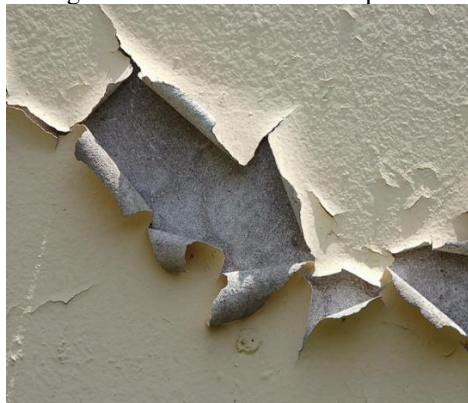
Figura 7 – Descascamento de pintura
