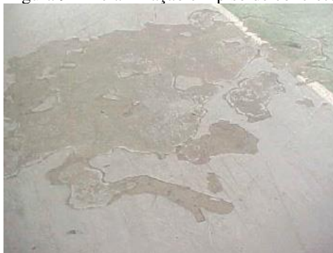
Figura 9 – Delaminação em piso de concreto
