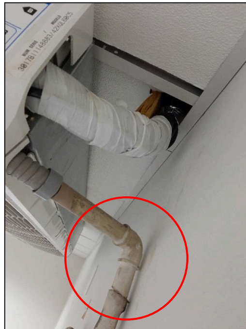
Figura 28. Conexões utilizadas para transporte da água condensada.
