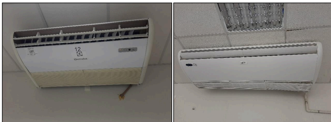
Figura 21 – a) Condicionador de ar Electrolux e b) Condicionador de ar Carrier.
