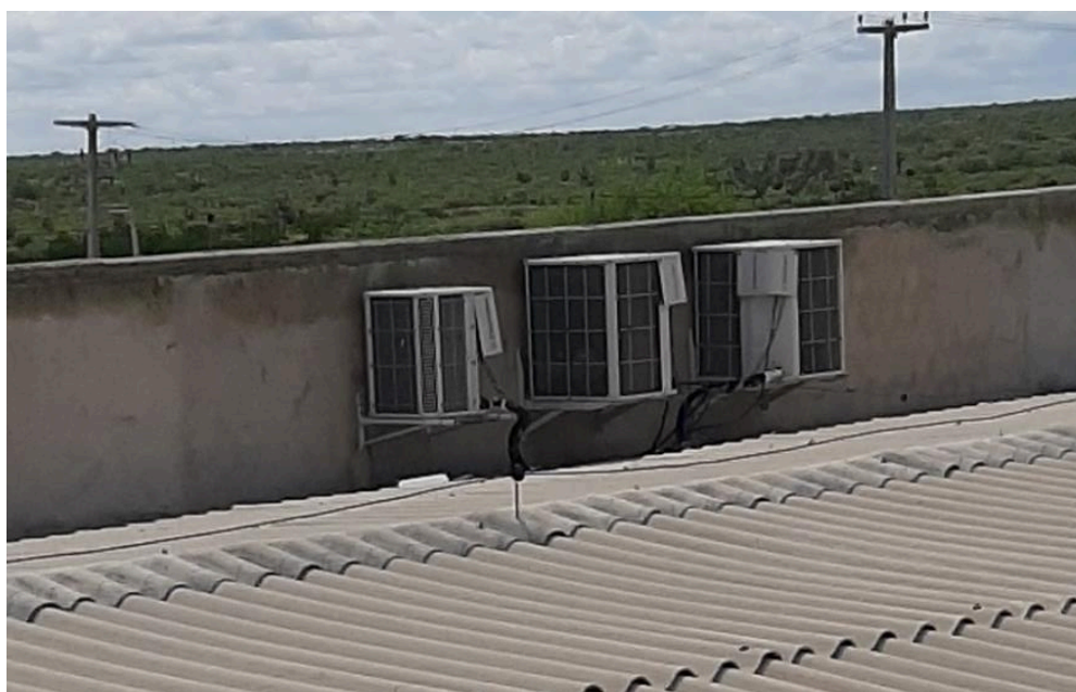
Figura 26. Instalação das condensadoras em mãos francesas sem calços de borracha.
