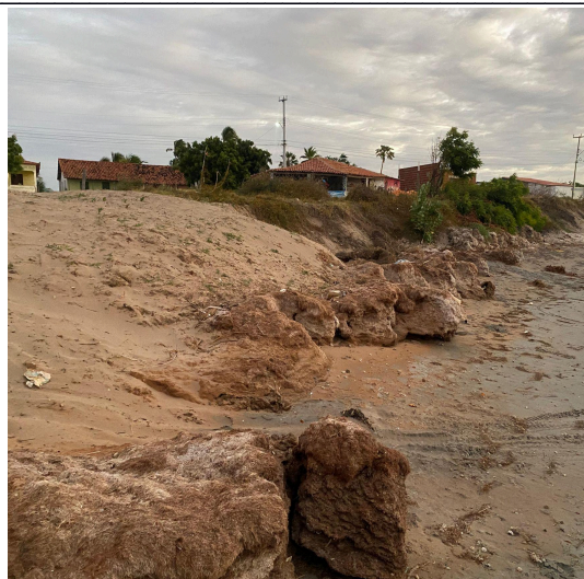
Figura 8. Encosta arenosa exposta à erosão em trecho da Praia de Barreiras. (Autoria própria)
