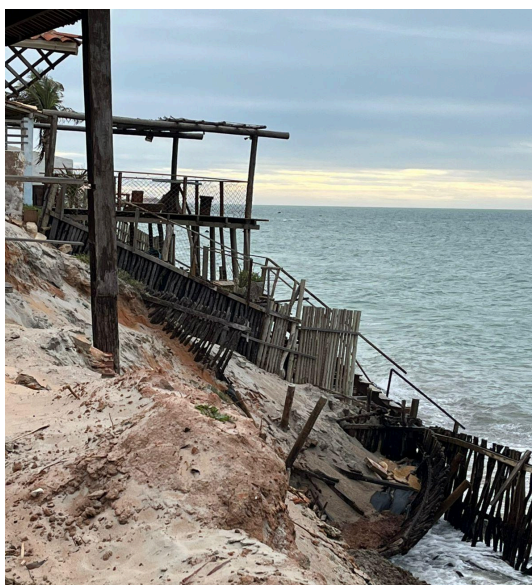
Figura 3. Estrutura de madeira com fundações comprometidas na Praia de Peroba. (Autoria própria)
