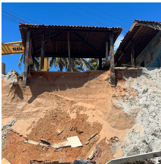
Figura 2. Estrutura danificada na Praia de Peroba. (Autoria própria)
