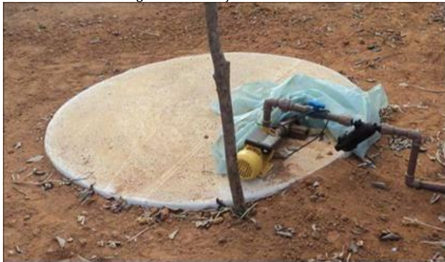
Figura 10 - Ilustração do reservatório.
