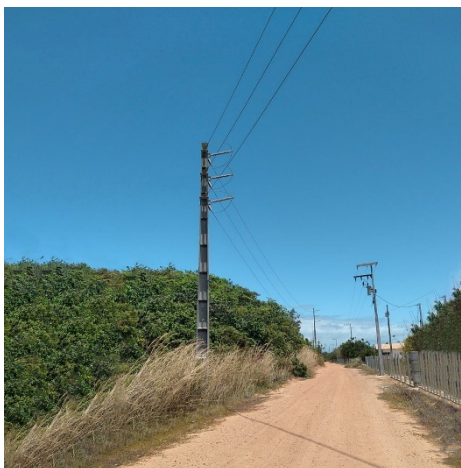
Figura 12 - Linha de transmissão do Parque Eólico de Uberaba.
