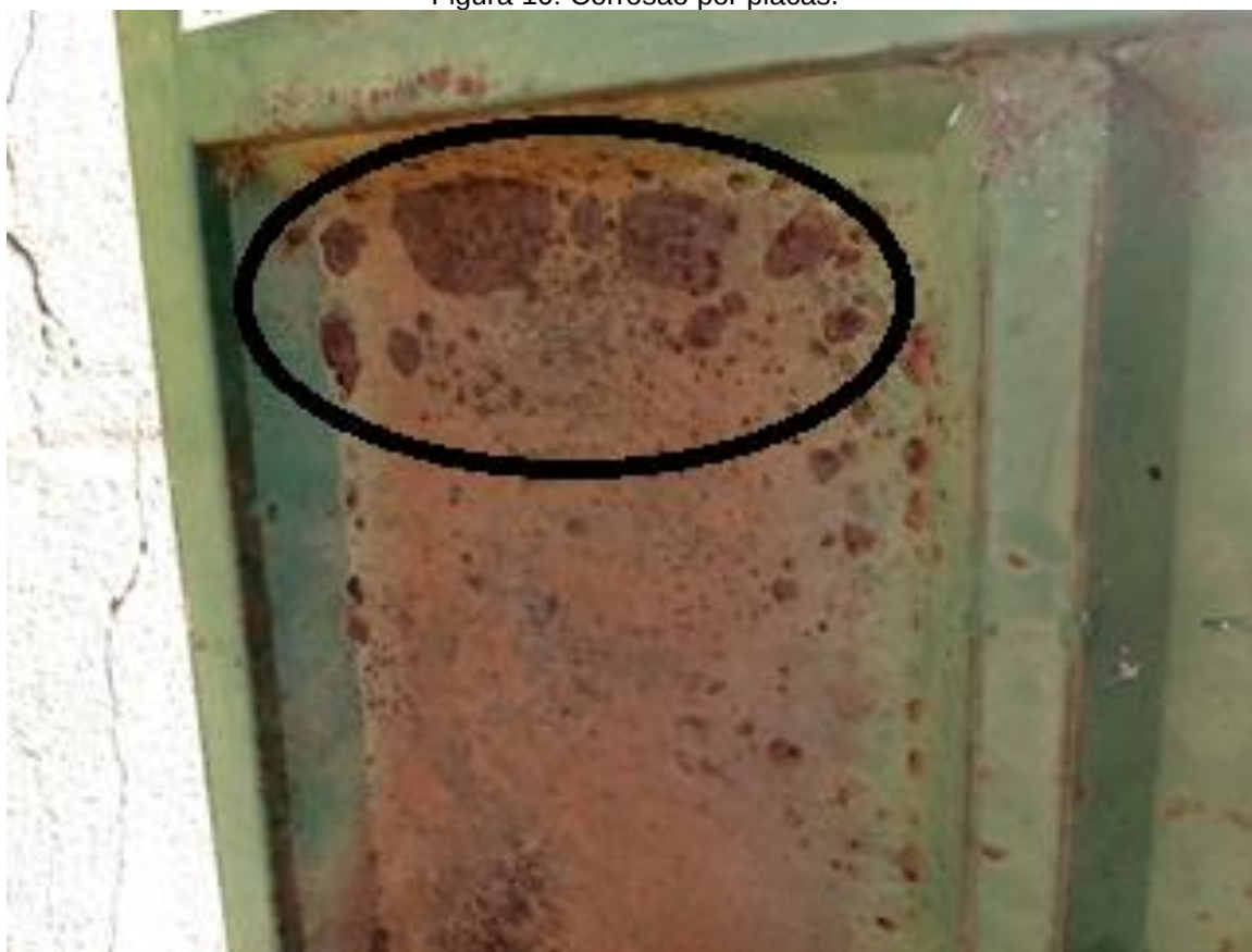
Figura 10: Corrosão por placas.
