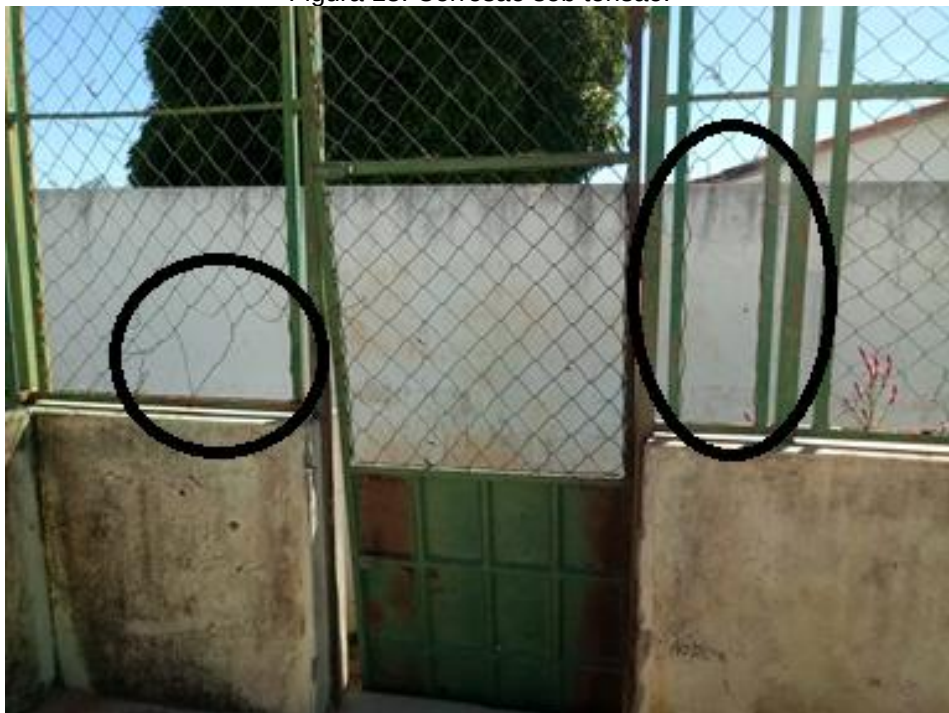
Figura 13: Corrosão sob tensão.
