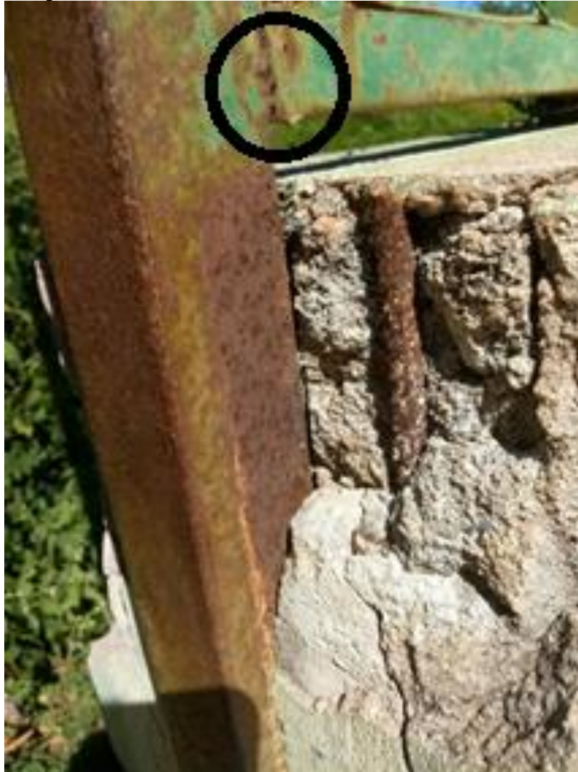
Figura 11: Corrosão no cordão de solda e no concreto armado.
