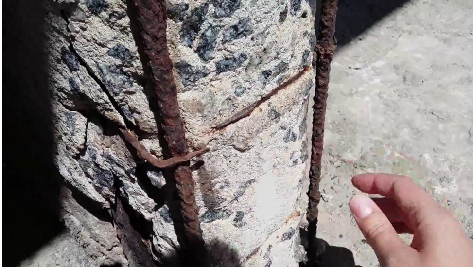
Figura 7: Corrosão do aço no concreto.
