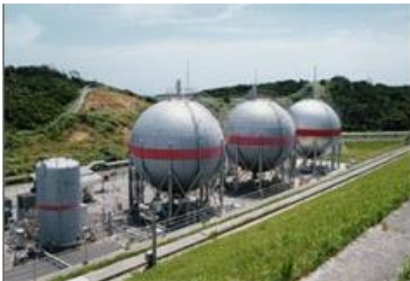
Figura 3: Tanques de armazenamento
