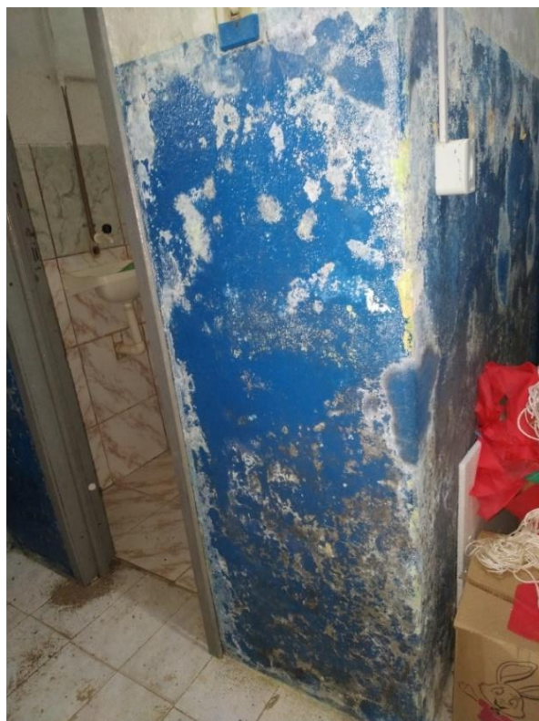
Figura 4 – Parte externa da parede de um banheiro com a presença de mofo, eflorescência e mancha de bolor.
