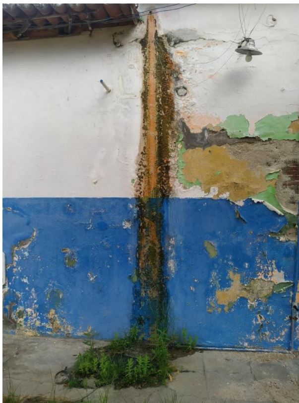
Figura 8 – Parede na parte externa da construção, com várias patologias como mofo, eflorescência, criptoflorescência, fissura, degradação do concreto.
