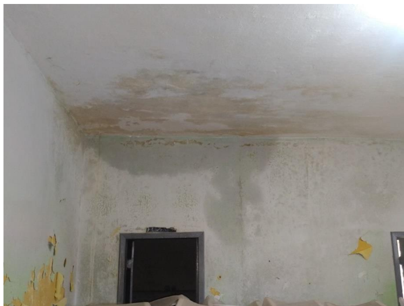
Figura 5 – forro do prédio e a parede com infiltração.
