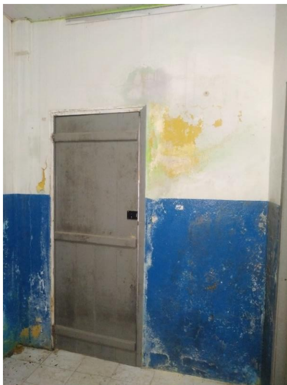
Figura 6 – Parede com presença de mofo, eflorescência, fissura e mancha de bolor e deterioração.
