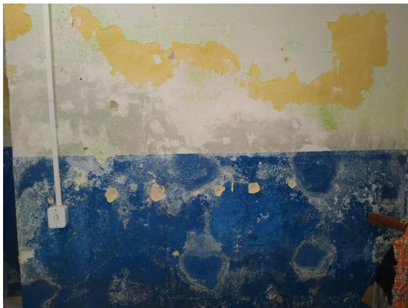
Figura 7 – parede interna do prédio com mofo, eflorescência, mancha de bolor e deterioração.
