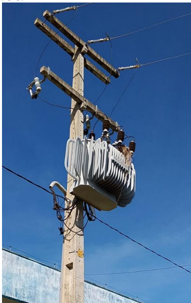
FIGURA 2. Subestação ao tempo do tipo aérea (autoria própria).
