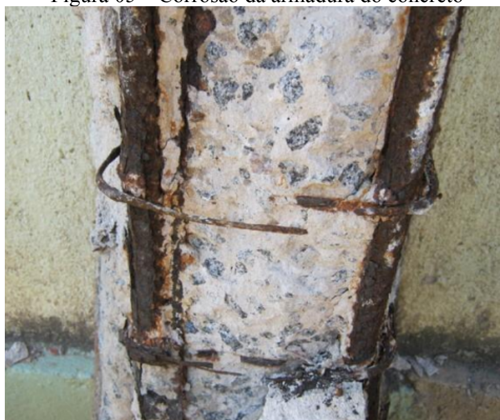
Figura 05 – Corrosão da armadura do concreto
