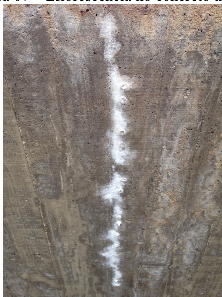
Figura 07 – Eflorescência no concreto armado
