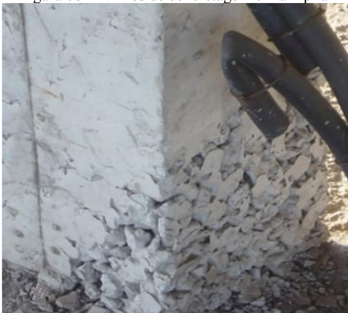
Figura 08 – Ninhos de concretagem em um pilar
