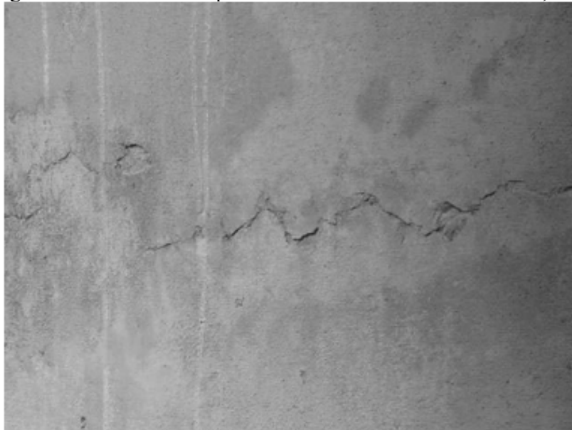
Figura 09 – Fissuras em pilar de concreto do Viaduto Cabral, MG
