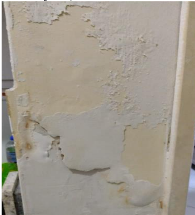
Figura 1: Depósito de eflorescência em alvenaria
