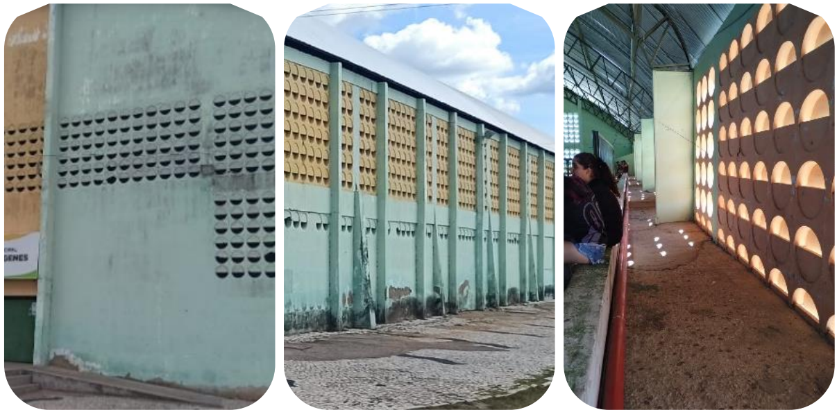
Figura 55, 56 e 57: Patologias aparentes nas fachadas externas do ginásio
