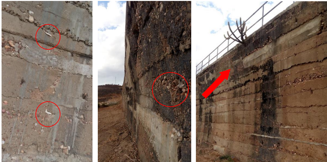
Figura 15 - Paramento de jusante, presença de raízes, desfragmentação e irregularidades.
