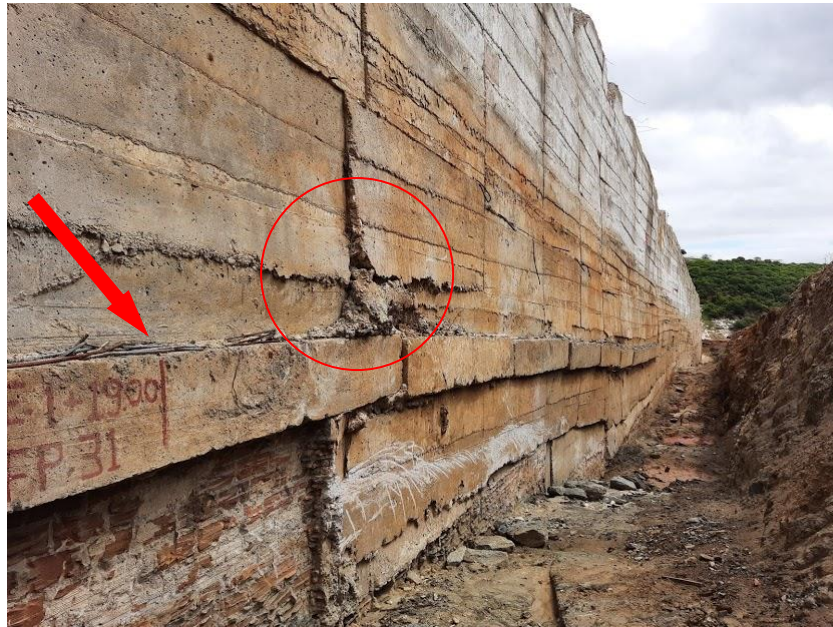
Figura 30- Irregularidades no paramento de montante.
