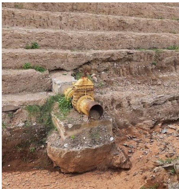
Figura 49 - Tomada d'água DN 500 mm, danificada.
