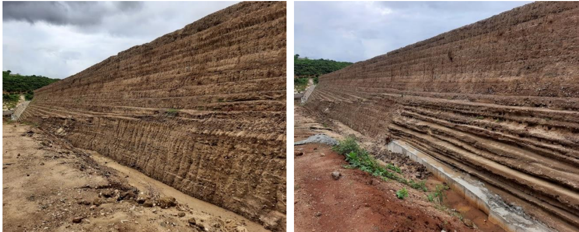
Figura 44 - Paramento de jusante, degraus sem geometria.
