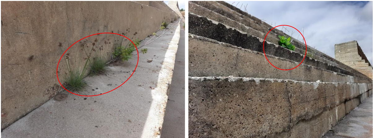
Figura 19- Vegetação nos degraus do vertedouro.
