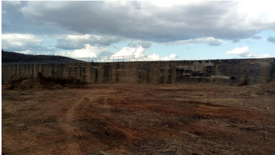
Figura 14- Paramento de jusante, antes da escarificação.
