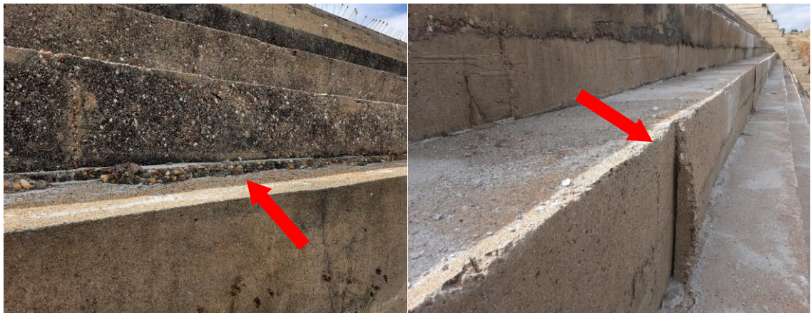
Figura 20- Degraus do vertedouro, ausência de uniformidade.
