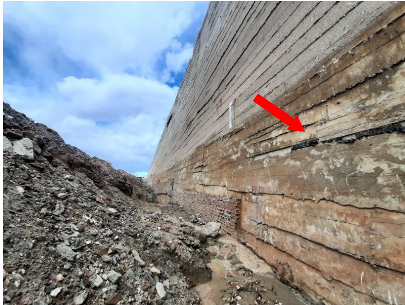
Figura 11- Paramento montante, resto de fôrma no concreto de face.
