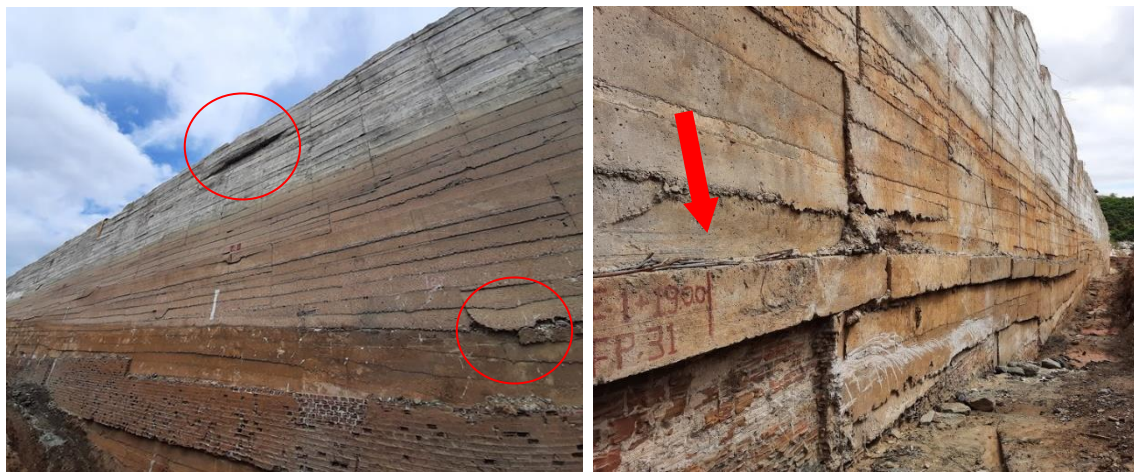
Figura 10- Detalhes do paramento de montante, irregularidades.
