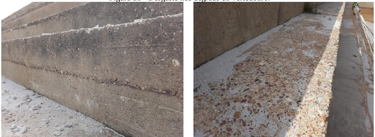
Figura 21 - Desgaste nos degraus do vertedouro.
