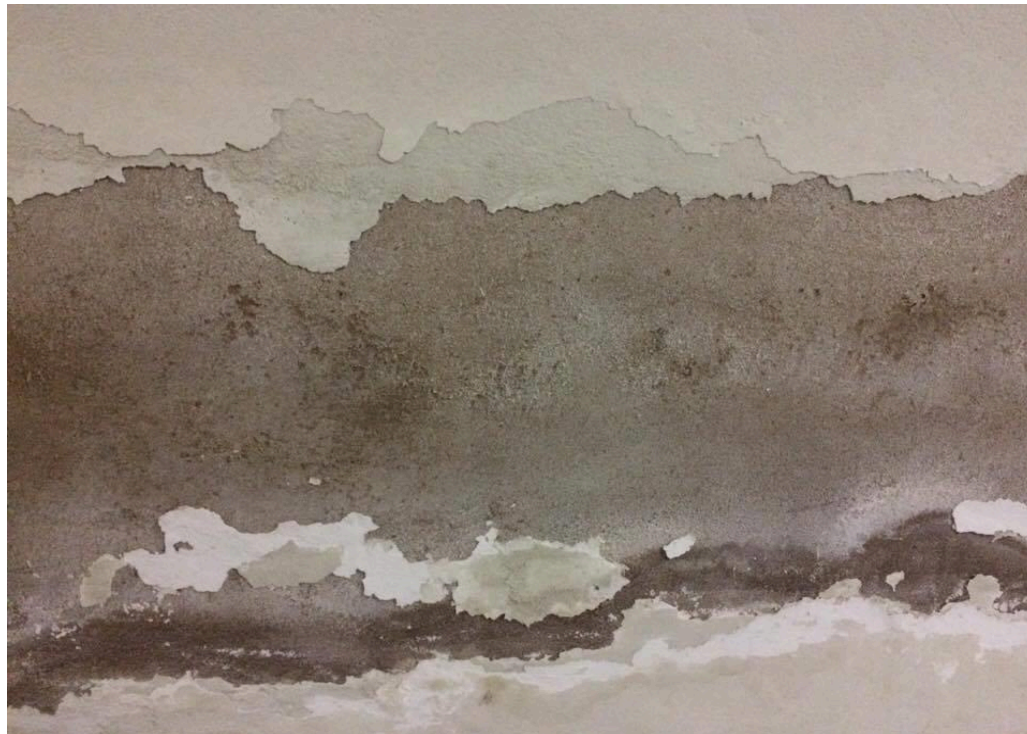
Figura 5 – degradação causada pela eflorescência
