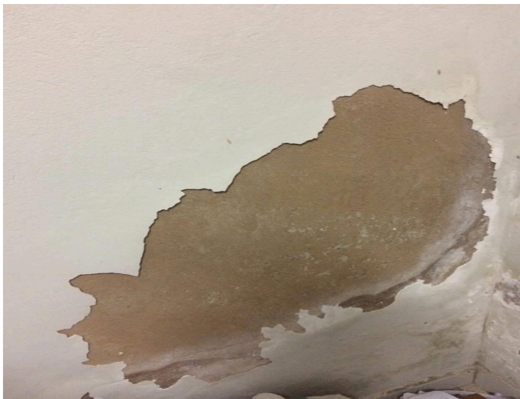
Figura 1 – Parede degradada por eflorescência
