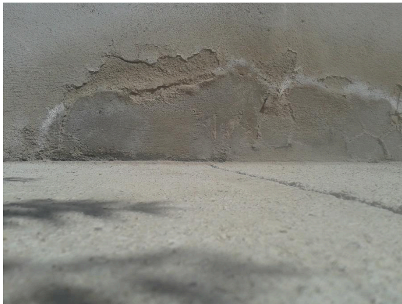
Figura 3: Depósitos salinos sobre o revestimento.
