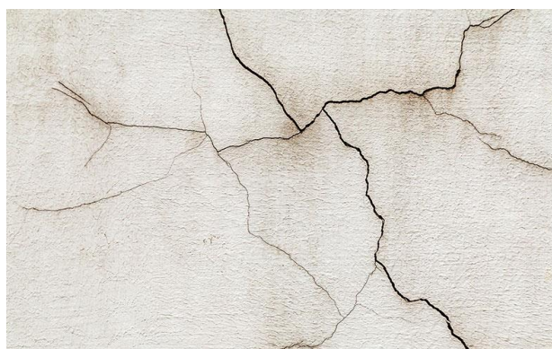
Figura 2: Fissuração por erro de cura.
