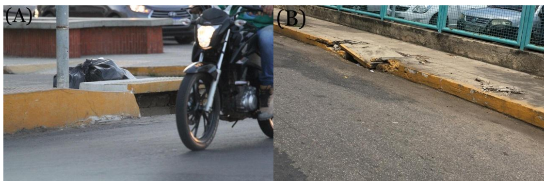
Figura 7. Sistemas de drenagem urbana de baixa eficiência. Fonte: Autoria própria (2020).
