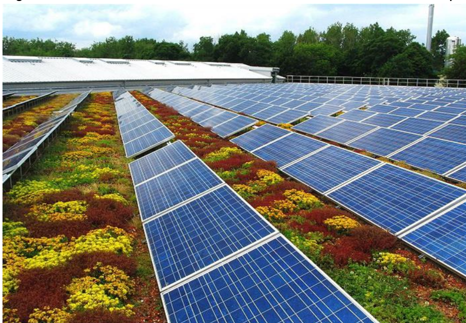
Figura 15 – Painéis FV e telhado verde instalados sobre um telhado predial
