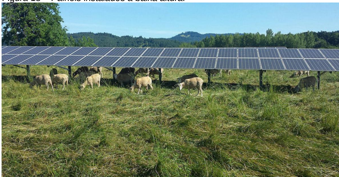
Figura 18 – Painéis instalados à baixa altura.
