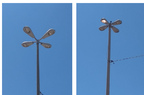
FIGURA 7. POSTES COM UMA LUMINÁRIA DE QUATRO PÉTALAS.
