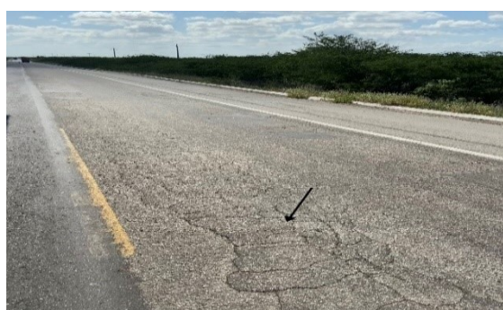
Figura 9 – Trincas tipo couro de jacaré (J)
