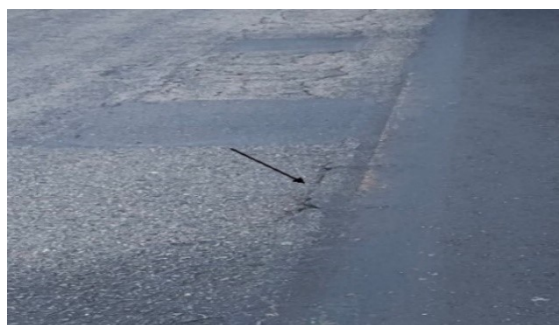
Figura 8 – Trincas longitudinais curtas (TLC)
