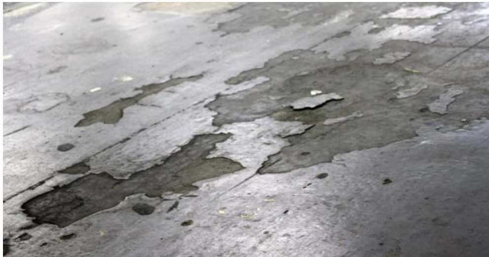
Figura 14: Desgaste do concreto por abrasão.
