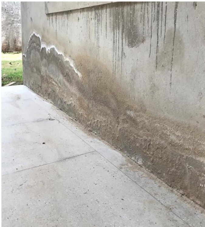
Figura 9: Eflorescência presente em uma construção.
