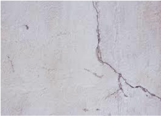
Figura 7: Fissuras em uma edificação;
