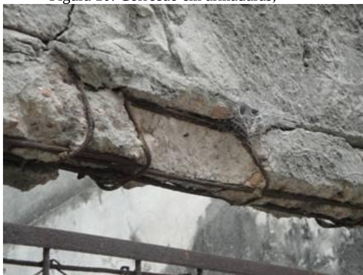
Figura 10: Corrosão em armaduras;
