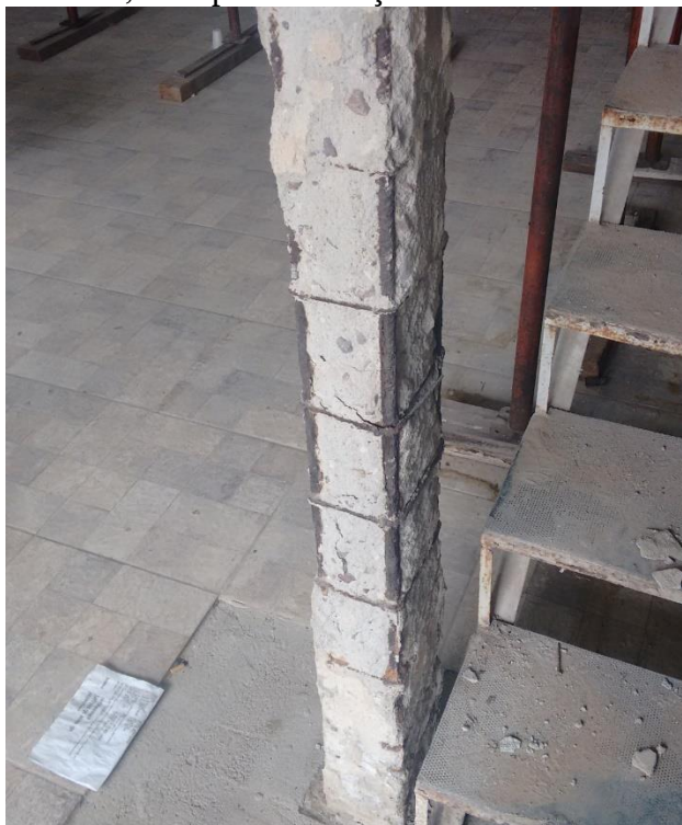
Figura 26: Pilar deteriorado, com perda da seção transversal do concreto e da armadura
