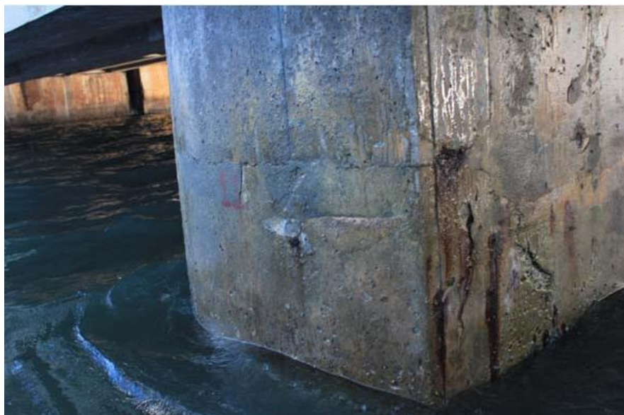
Figura 15: Desgaste do concreto por erosão.
