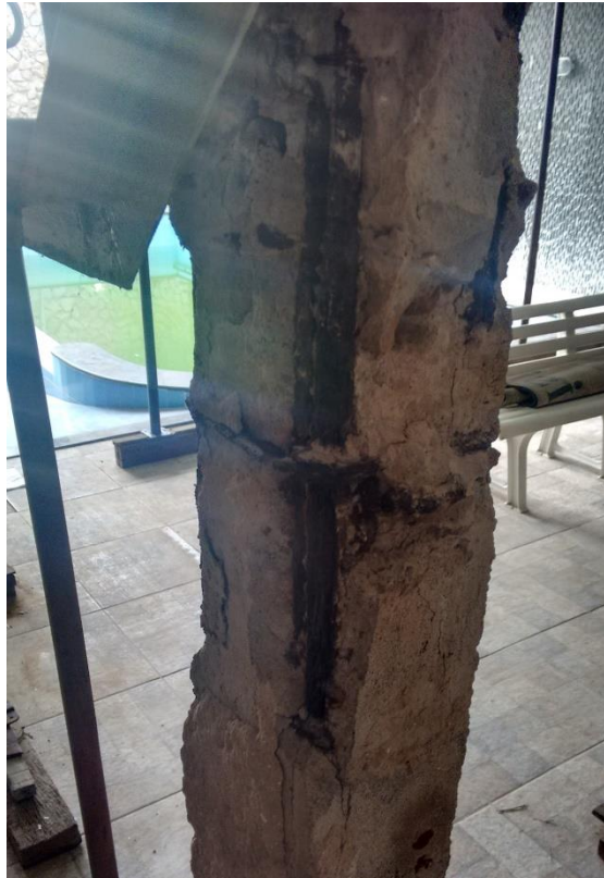
Figura 27: Pilar deteriorado, apresentando cobrimento insuficiente;
