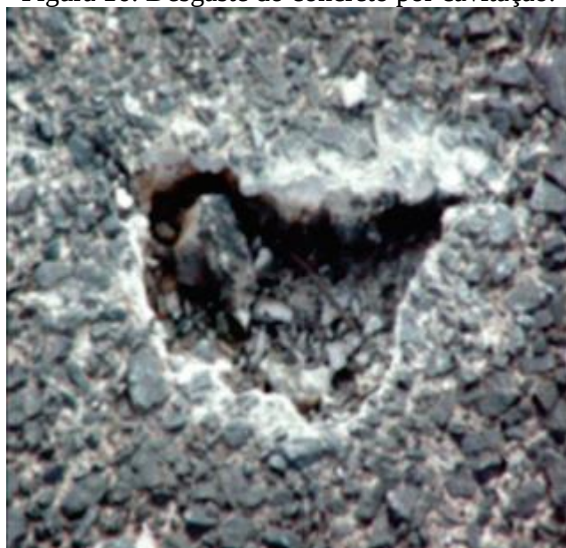
Figura 16: Desgaste do concreto por cavitação.
