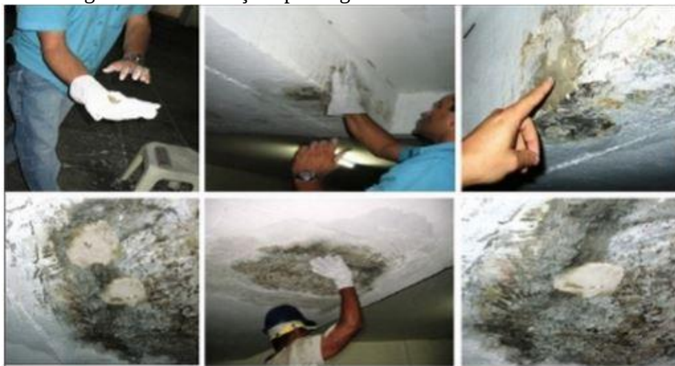
Figura 2: Manifestações patológicas em estruturas de concreto
