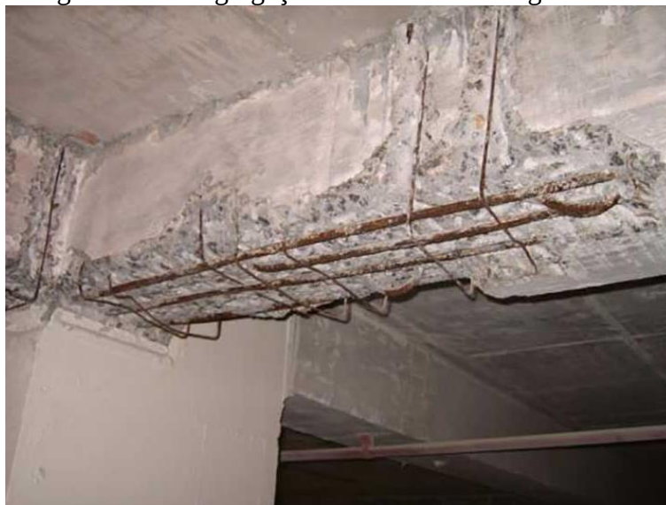
Figura 13: Desagregação do concreto em viga.
