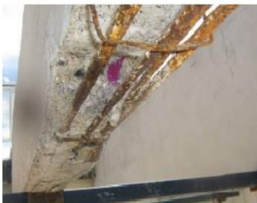
Figura 12: Reação da fenofitaleína em uma viga.
