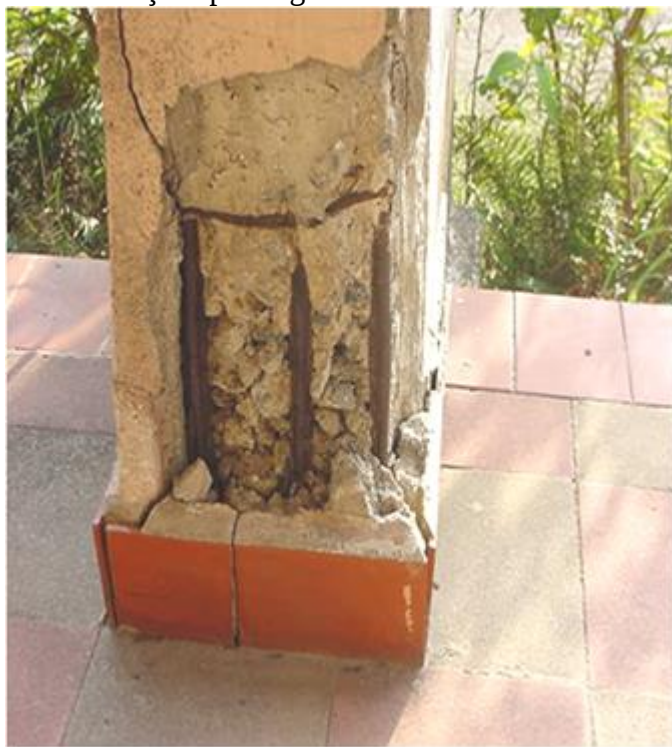
Figura 3: Manifestações patológicas em estruturas de concreto armado
