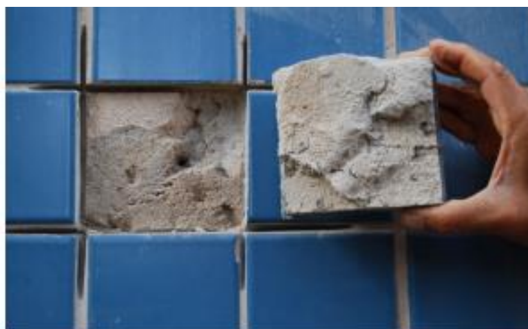
Figura 7 – Destacamento do revestimento cerâmico
