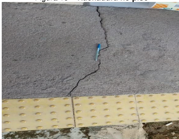
Figura 13 – Rachadura no piso
