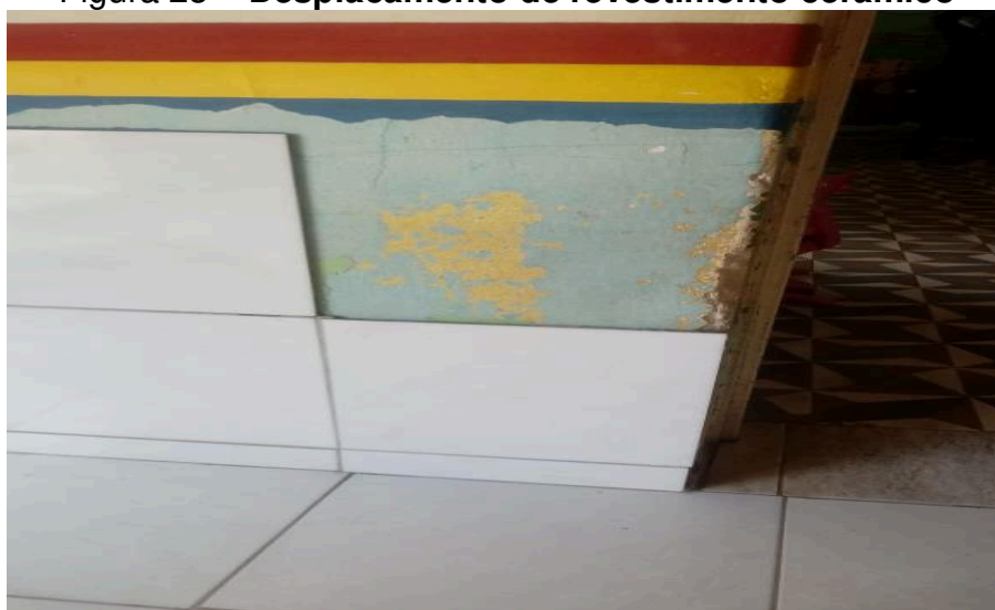
Figura 23 – Deslocamento de revestimento cerâmico
