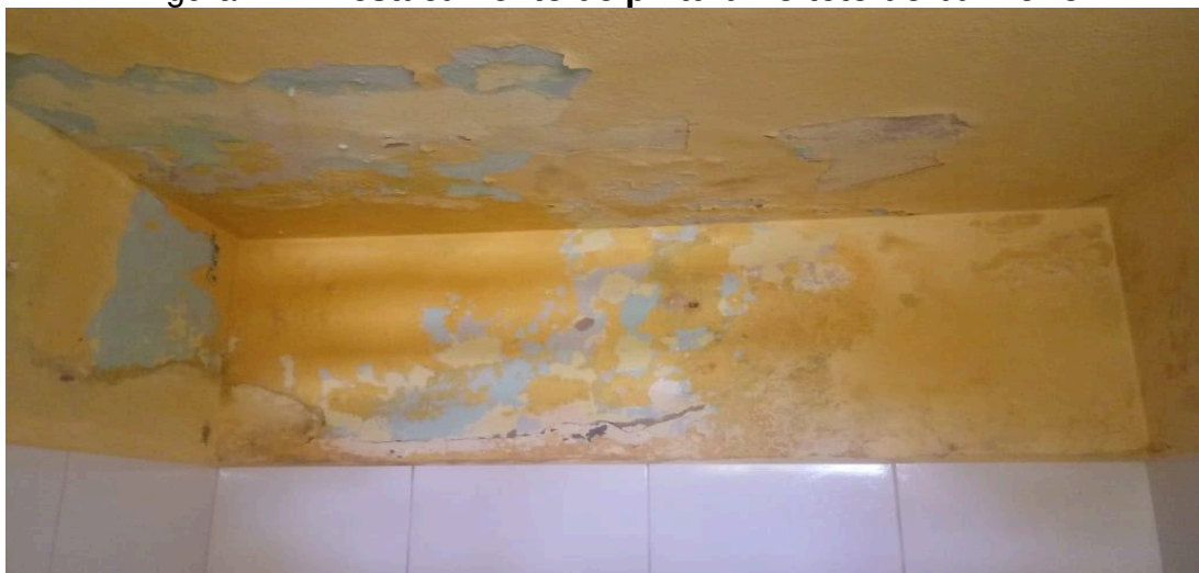
Figura 22 – Destacamento de pintura no teto do banheiro
