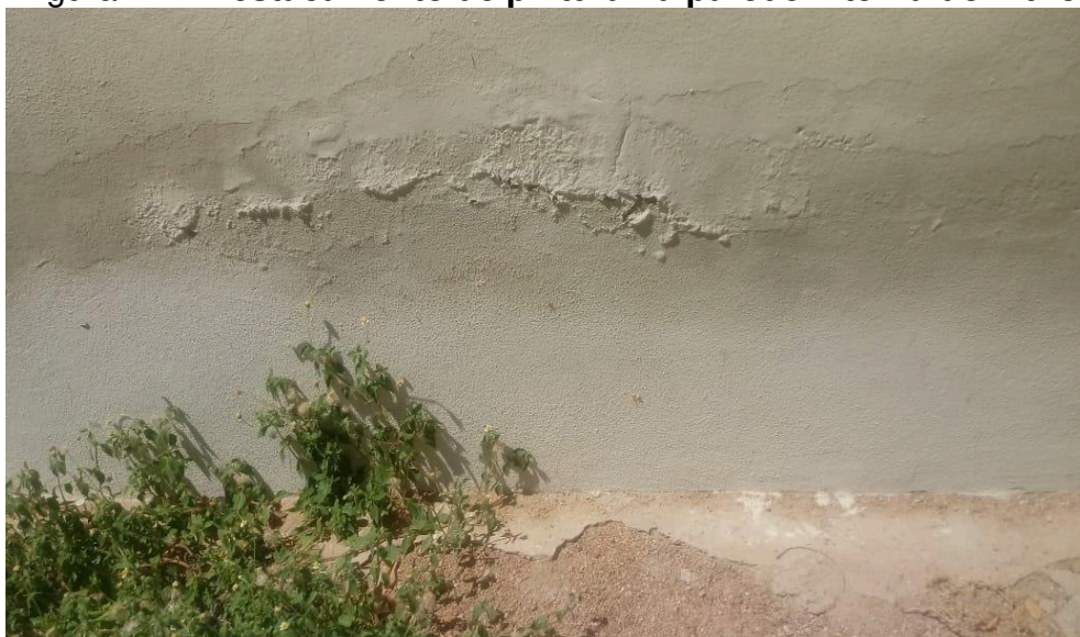
Figura 17 – Destacamento de pintura na parede interna do muro
