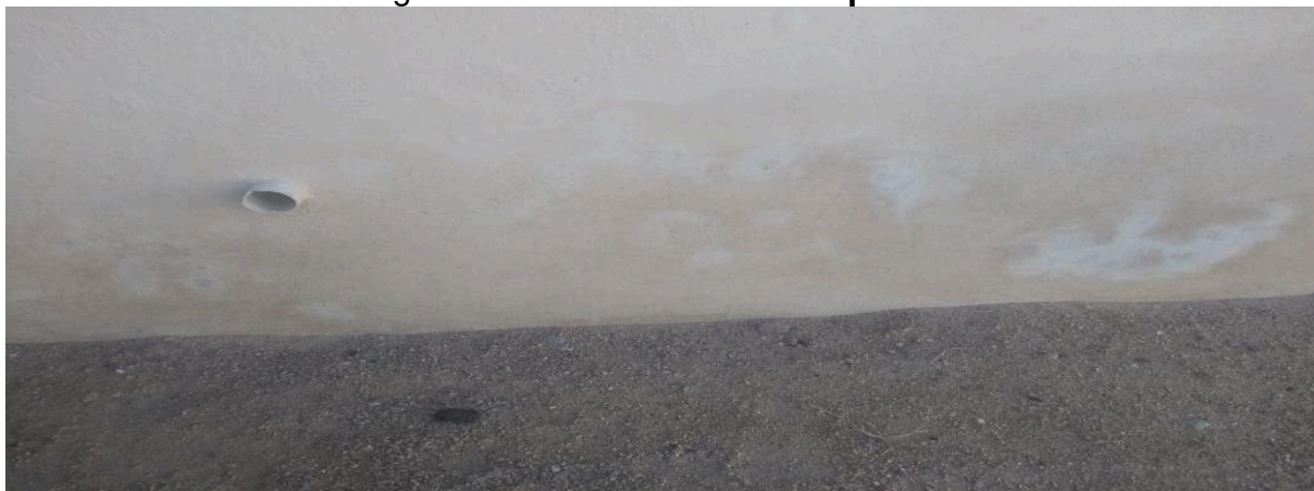
Figura 14 – Destacamento de pintura
