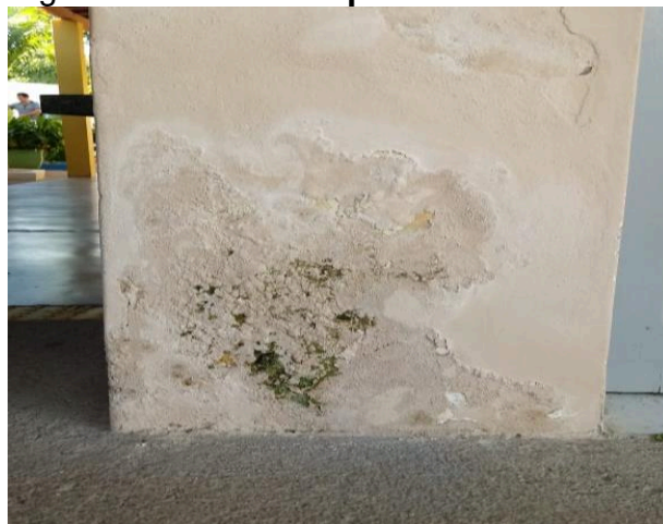
Figura 11 – Bolor na parede do banheiro
