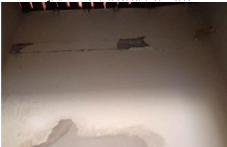
Figura 24 – Elemento estrutural danificado
