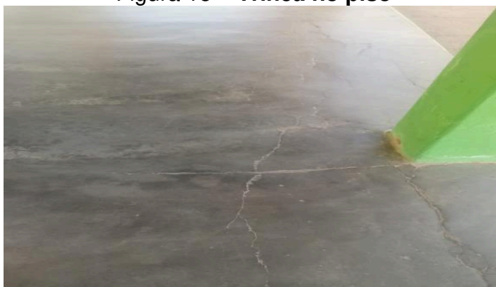
Figura 18 – Trinca no piso
