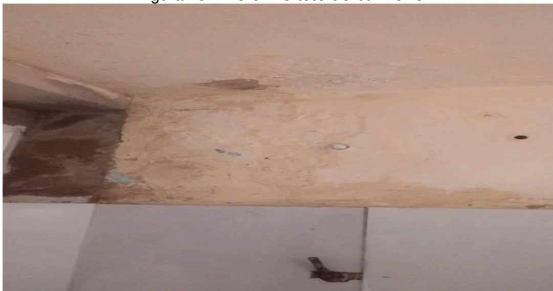
Figura 25 – Bolor no teto do banheiro
