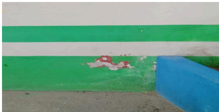
Figura 10 – Destacamento da pintura na fachada
