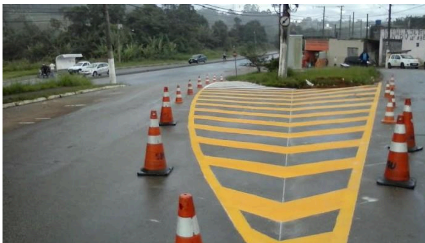
Figura 13 – Marcas de canalização
