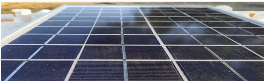
Figura 4. Superfície de módulo fotovoltaico parcialmente coberto por uma fina camada de areia. (Autoria própria)
