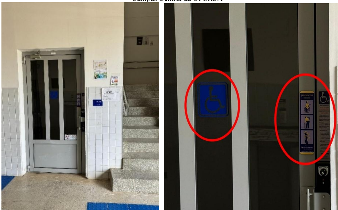
Figura 11: Plataforma elevatória e escada para acesso as salas de aula no pavimento superior do Bloco B, Campus Central da UFERSA
