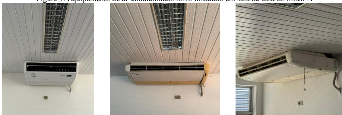
(A): ar-condicionado novo; (B e C) ar-condicionados precisando de manutenção. Fonte: Dados da pesquisa (2025).
