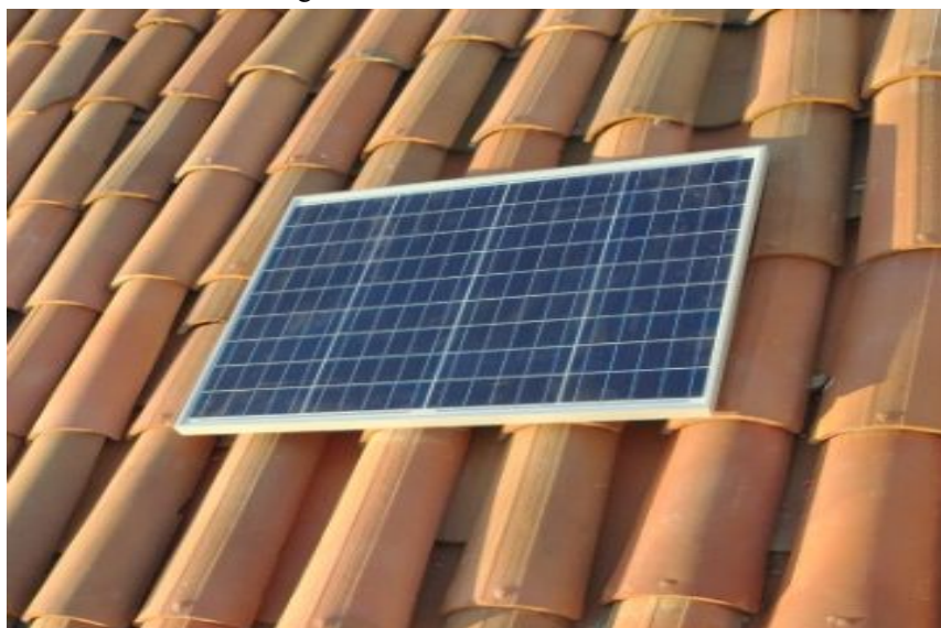
Figura 5: Painel solar Fotovoltaico
