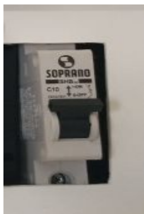
Figura 6: Disjuntor Ac monopolar
