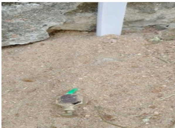
Figura 9: Sistema de aterramento do módulo solar.
