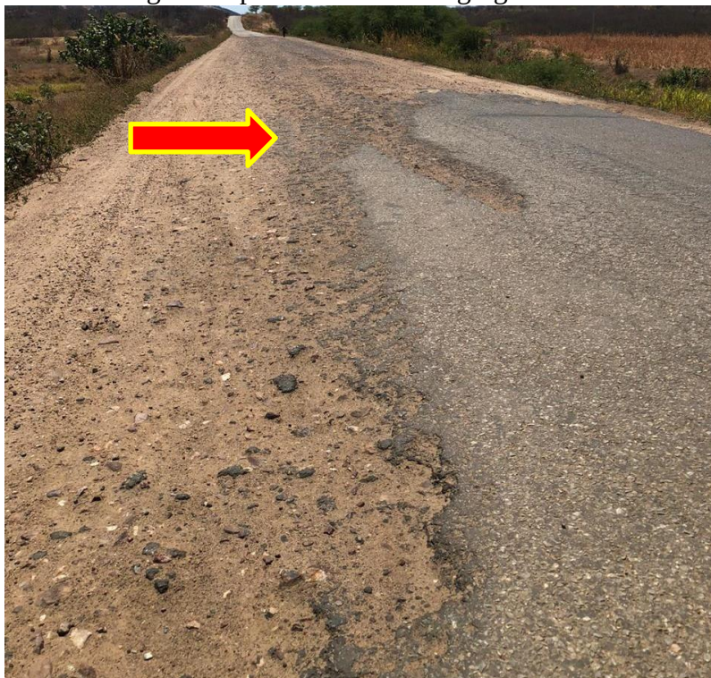
Figura 18: Patologia do tipo soltamento do agregado da mistura asfáltica
