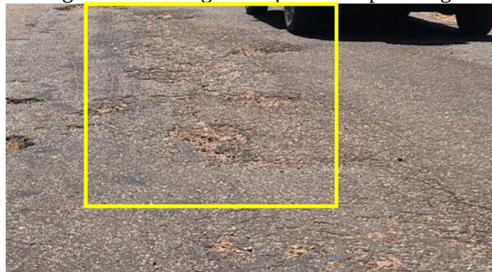
Figura 17: Patologia do tipo trincas por fadiga
