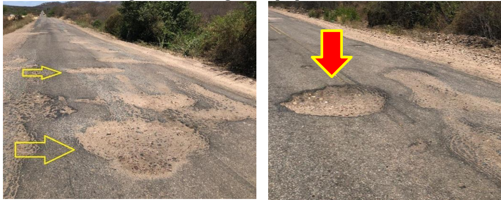
Figura 16: Patologia do tipo panela ou buraco
