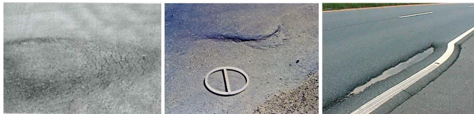
Figura 13: Fotografias do escorregamento de revestimento
