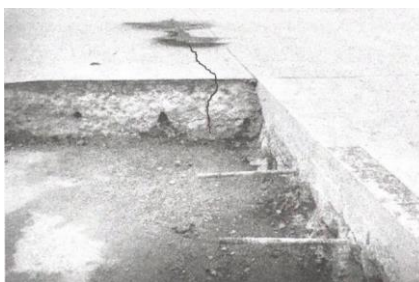
Figura 4: Trinca Longitudinal (Corte com 2 cm, sendo o especificado 8cm).
