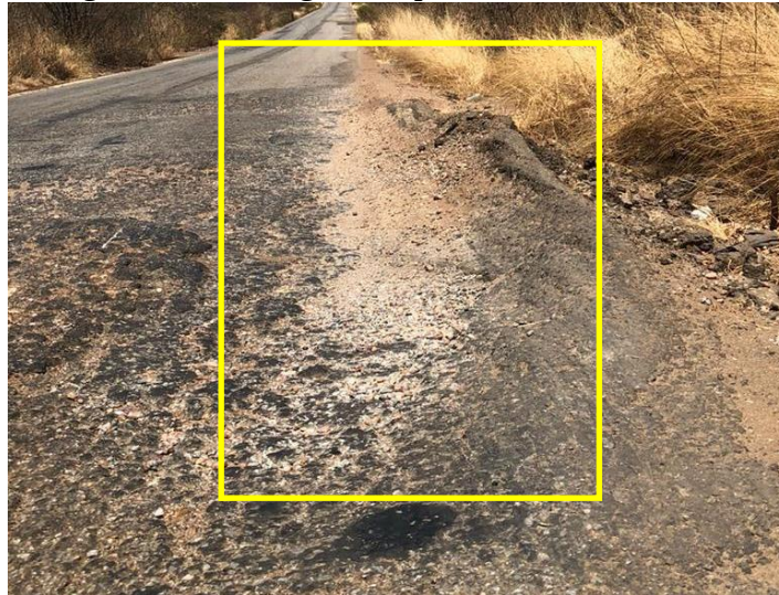
Figura 19: Patologia do tipo afundamento
