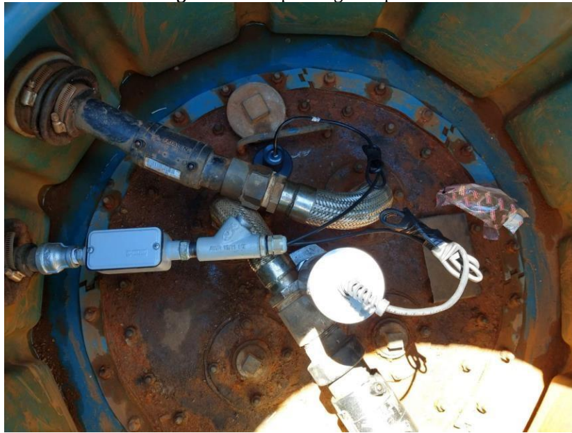
Figura 26: Sump do segundo posto
