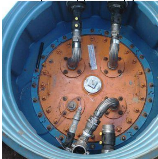
Figura 18: Exemplo de sump (caixa de inspeção do tanque)
