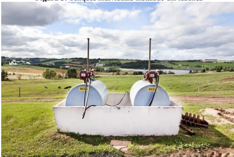
Figura 5: Tanques individuais instalado em fazenda
