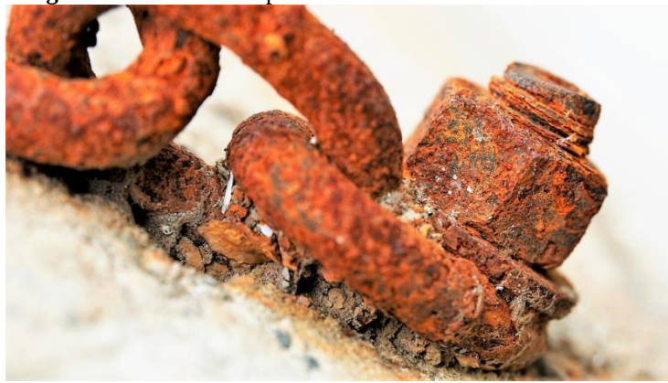
Figura 10: Corrente em processo de corrosão uniforme
