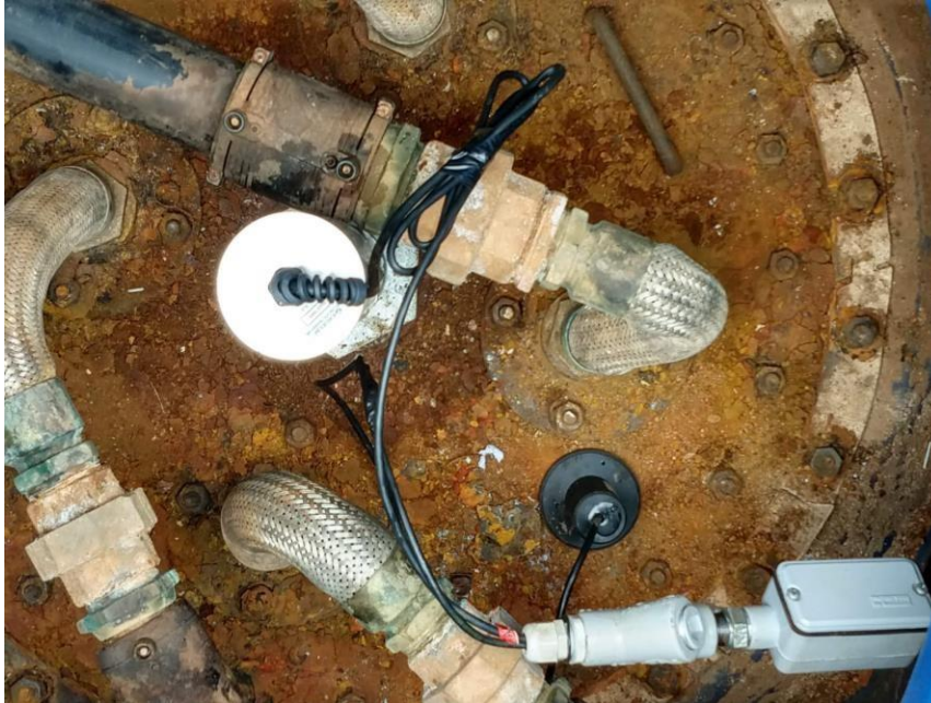
Figura 25: Foto ampliada da corrosão
