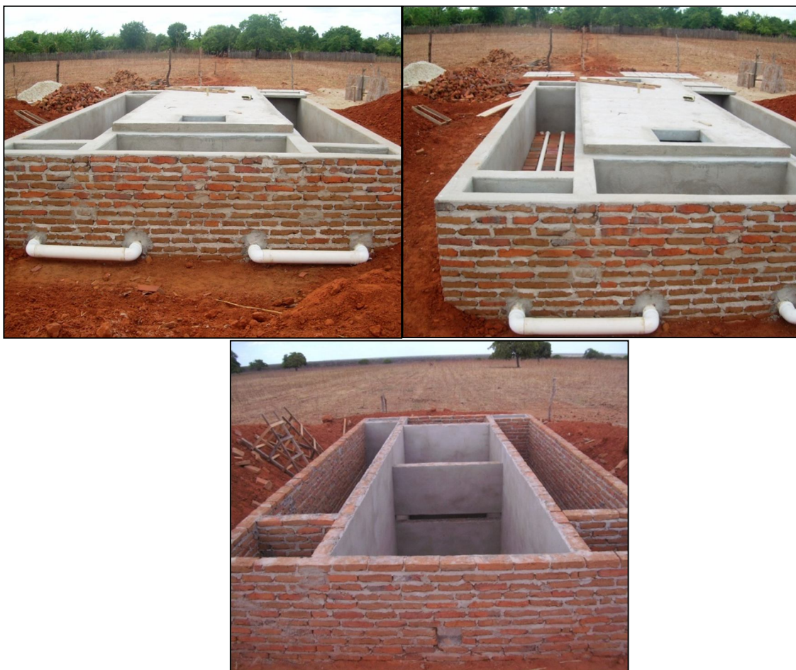
Figura 4 – Fotos do sistema piloto construído no assentamento Milagres em Apodi – RN. Fonte: Arquivo próprio.
