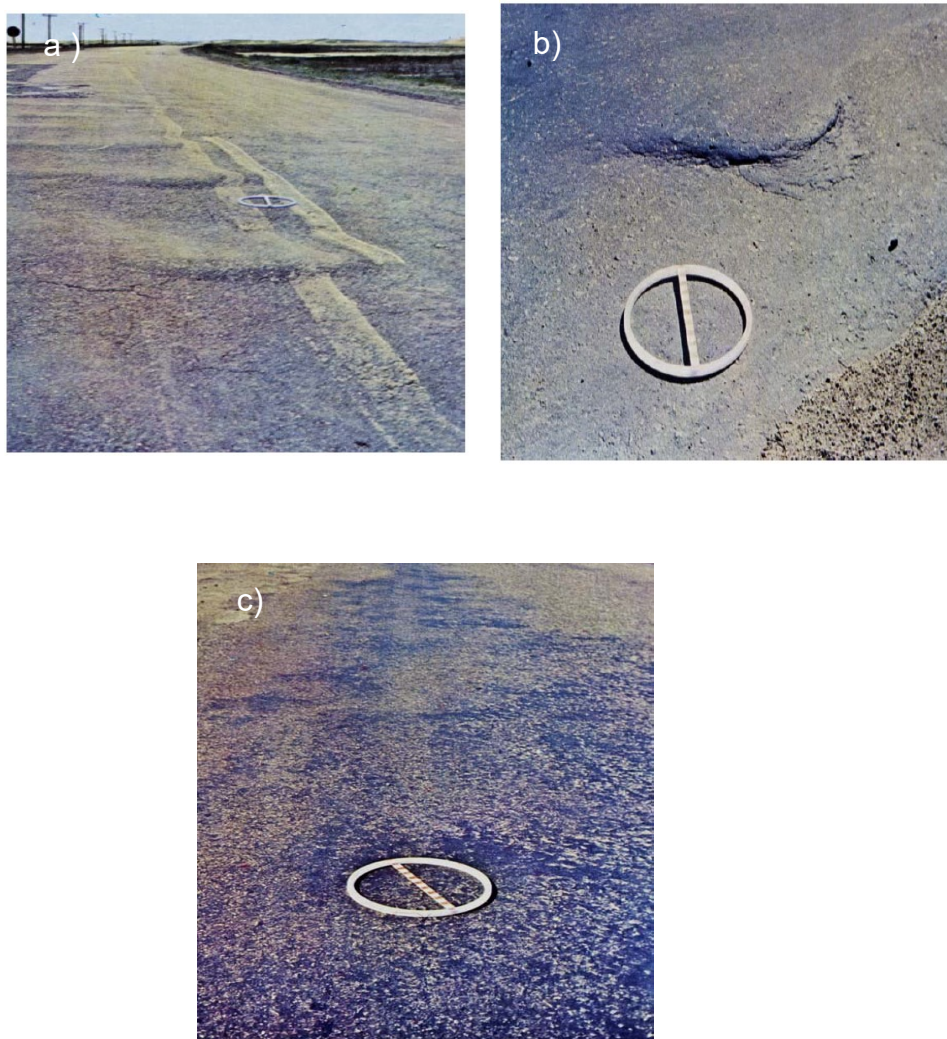
Figura 05 – a) Ondulação, b) Escorregamento, c) Exsudação.
