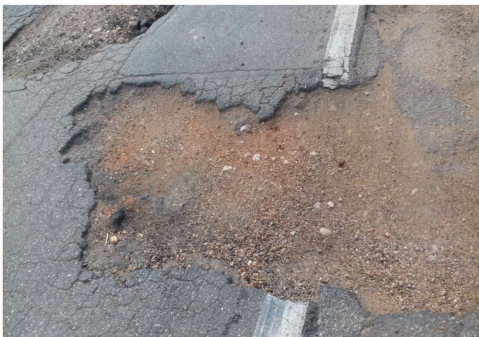
Imagem 03: Panelas no pavimento.
