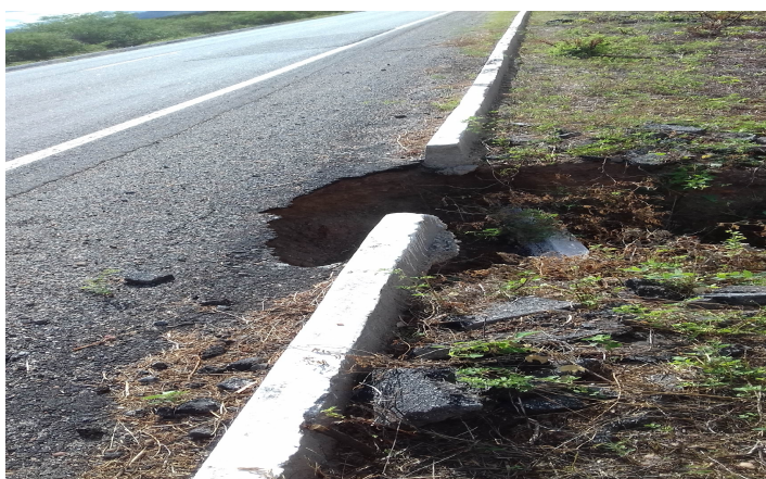
Imagem 04: Estrutura do pavimento carreado pela água da chuva.
