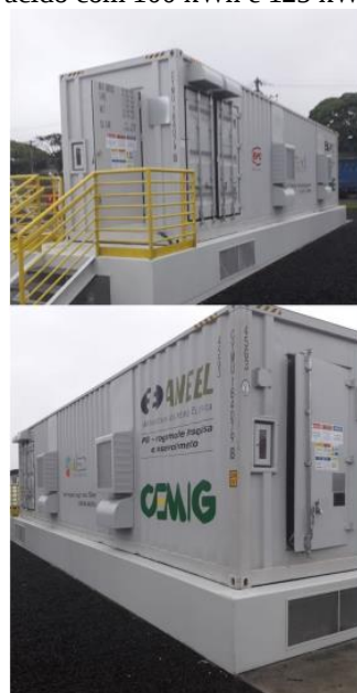
Figura 4. Banco de baterias de íon de lítio e de chumbo ácido instalado em Uberlândia/MG (GREENER, 2021).
