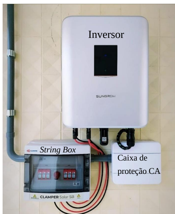
Figura 8. Inversor, String Box e Caixa de Proteção CA instalados.
