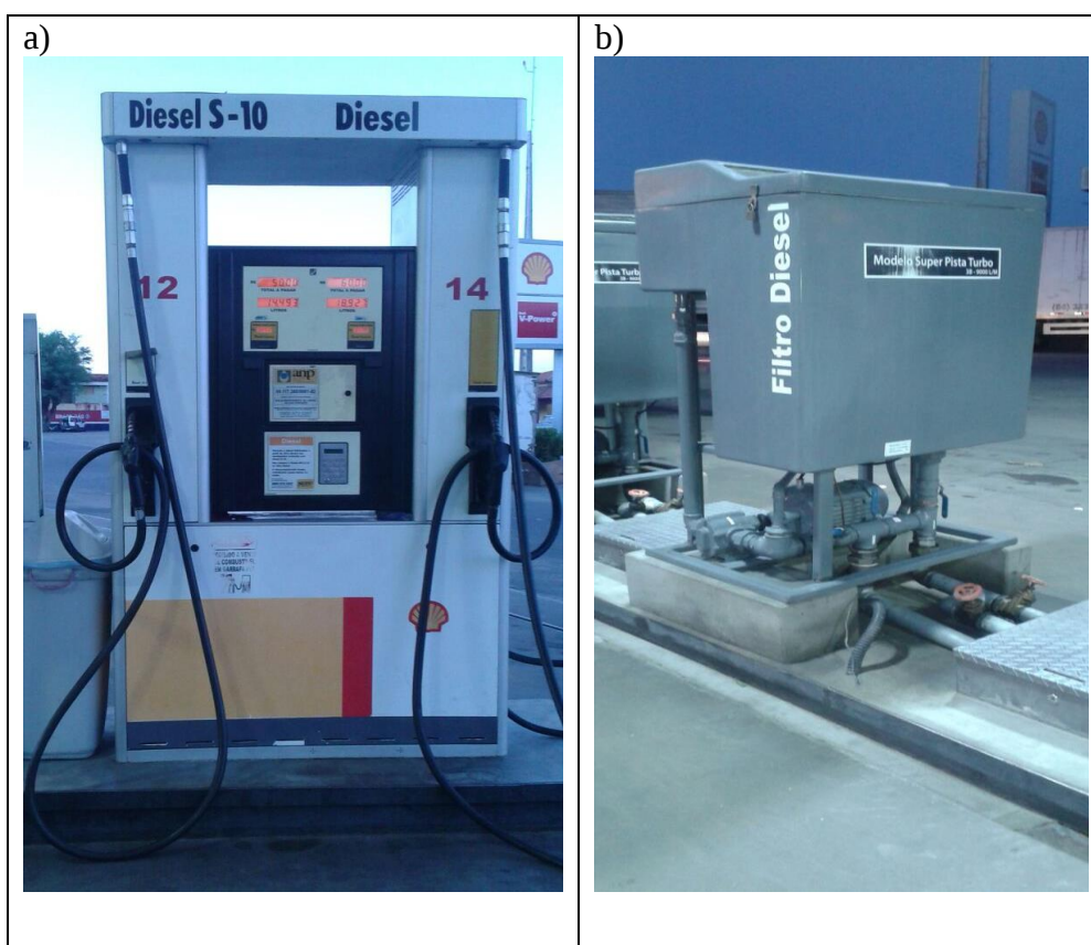
Figura 6 – Equipamentos do pátio de abastecimento: a) Bomba de abastecimento e b) Filtro de diesel
