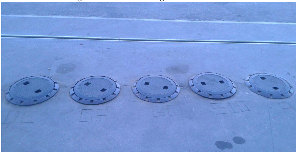
Figura 7 – Área de descarga do combustível
