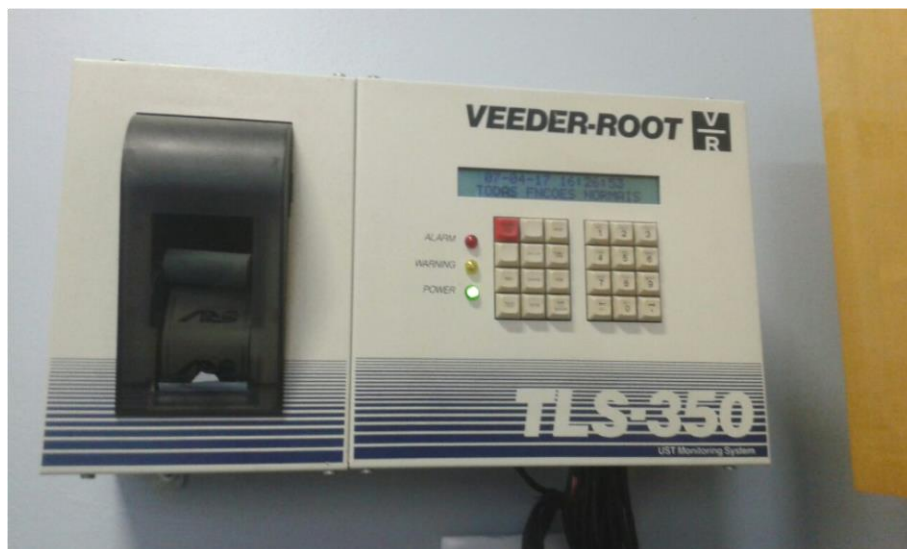
Figura 8 – Medidor de tanque automático.
