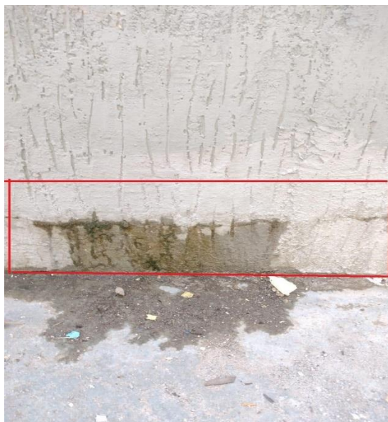
Figura 18 – Fissura na Cisterna
