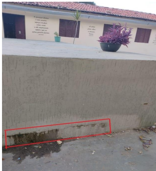
Figura 17 – Fissura na Cisterna
