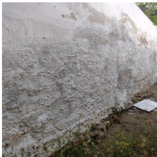
Figura 21 – Eflorescência na parede do muro
