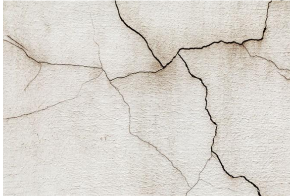
Figura 1 – Exemplo de Fissuras
