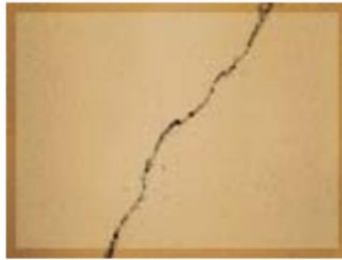
Figura 4 – Exemplo de Trincas
