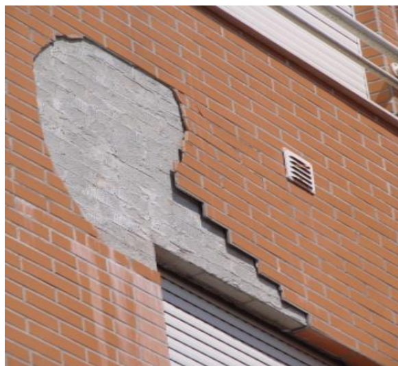
Figura 7 – Exemplo de deslocamento de revestimento de fachadas
