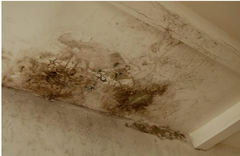
Figura 6 – Exemplo de Mofo no teto
