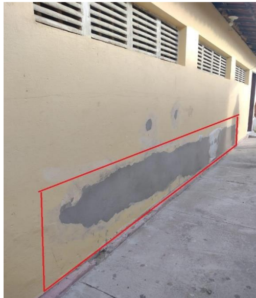
Figura 20 – Eflorescência na parede externa da sala de aula
