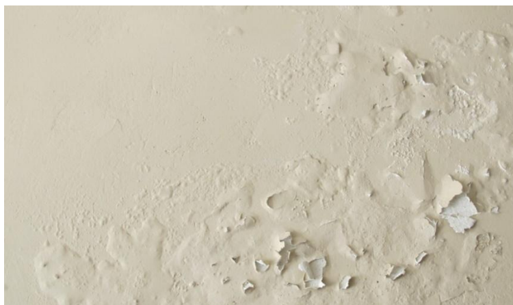
Figura 5 – Bolhas na parede interna
