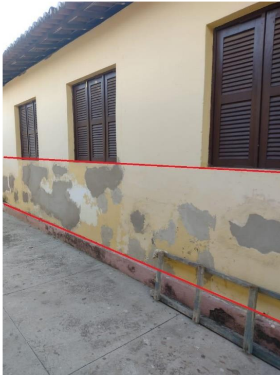
Figura 19 – Eflorescência na parede externa da sala de aula
