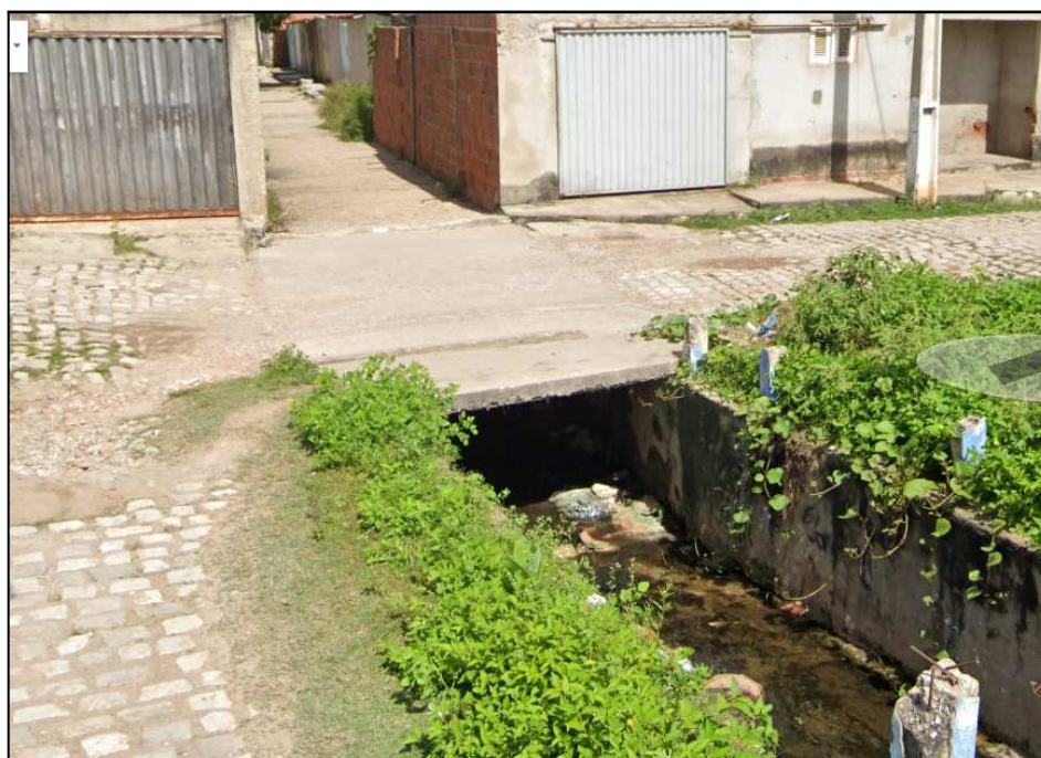
Figura 9 - Canal passando com disposição para resíduos entre as residências do bairro Dom Jaime Câmara, em Mossoró - RN
