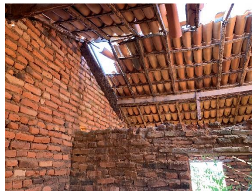
Dano na estrutura do telhado
