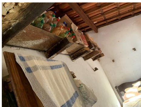
Estrutura aparente do caixão no quarto 01
