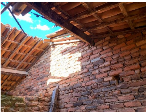
Dano na estrutura do telhado
