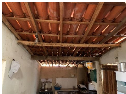
Madeira menor no telhado da cozinha
