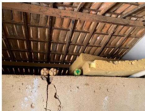
Fissura na meia parede
