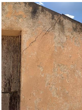
Fissura na parede
