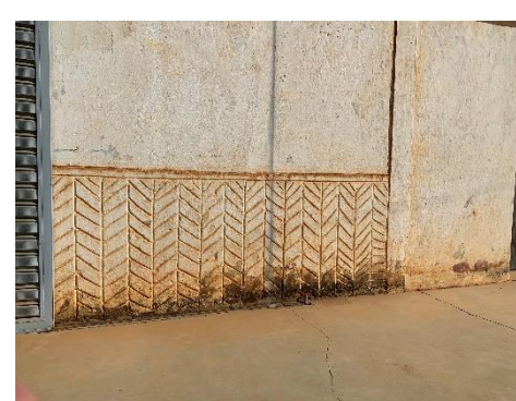
Ladrilhos na fachada frontal
