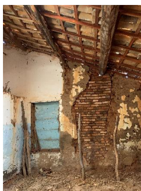
Desgaste da alvenaria
