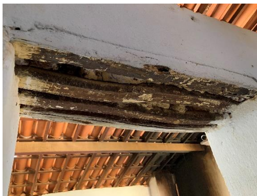
Vergas das esquadrias
