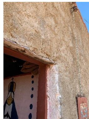
Verga das esquadrias
