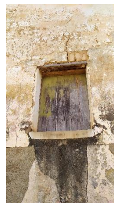
Verga das esquadrias
