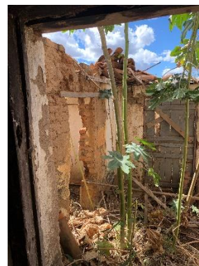
Parte em degradação
