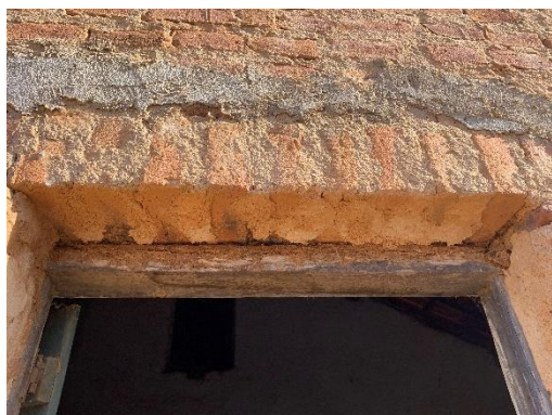
Verga das esquadrias
