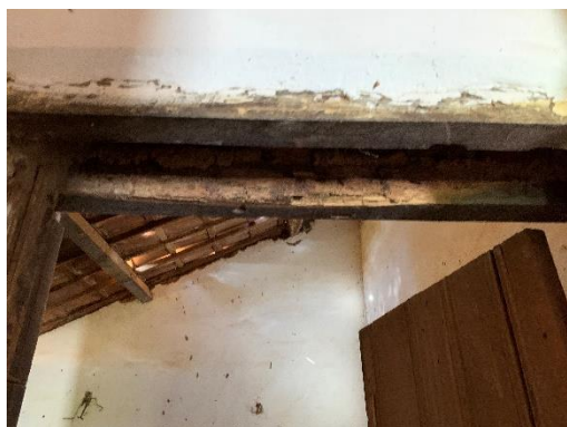
Verga das esquadrias
