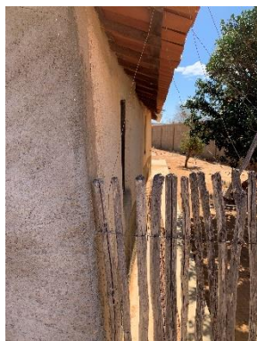
Parede torta devido a taipa
