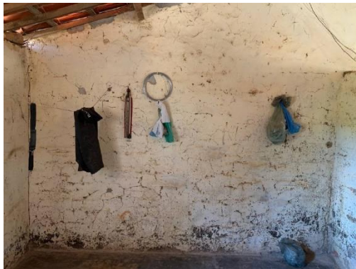
Parede do quarto 02 – reboco em barro comum
