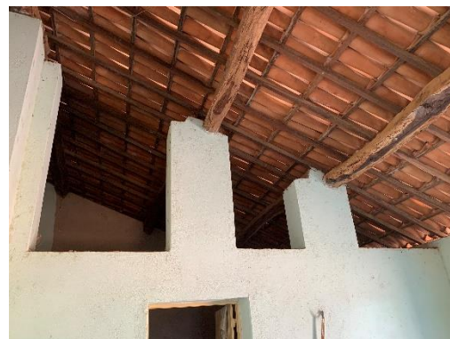
Assentamento do telhado na alvenaria
