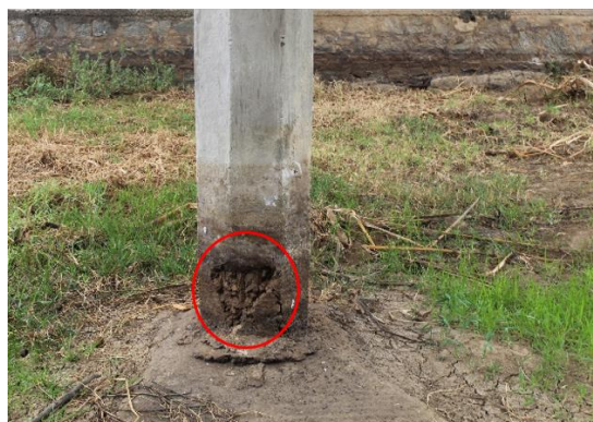
(d) deslocamento do concreto
