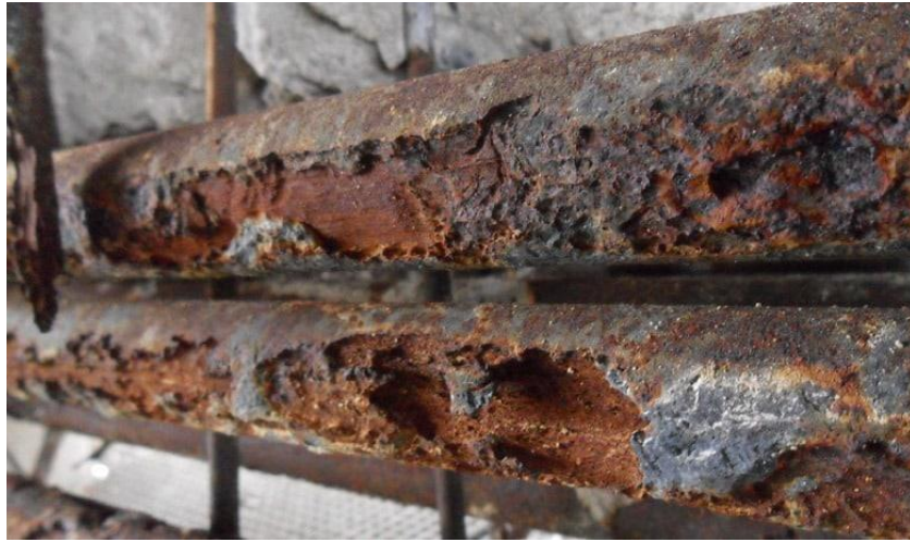
Figura 4 - Corrosão por pite.
