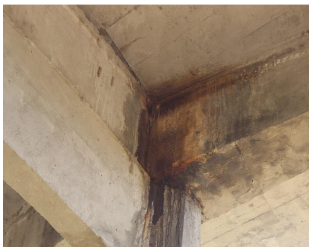
(a) manchas de corrosão
