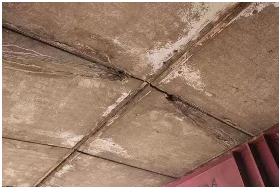
Figura 5 - Lixiviação do concreto
