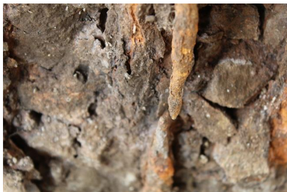
(c) ruptura das armaduras
