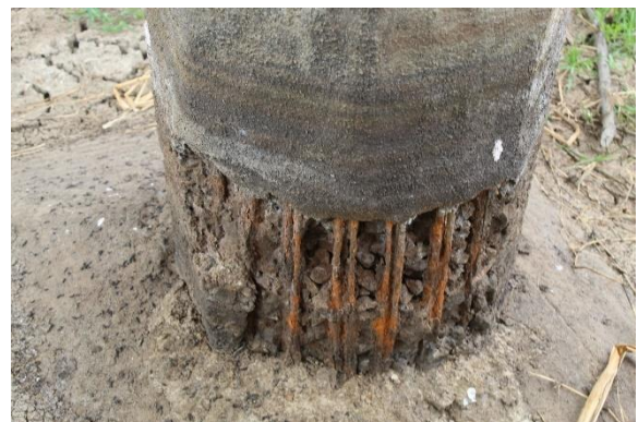
(b) exposição de armaduras
