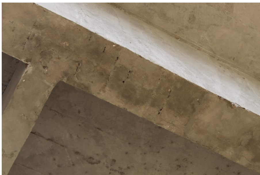
Figura 14 - Danos na viga longarina.
