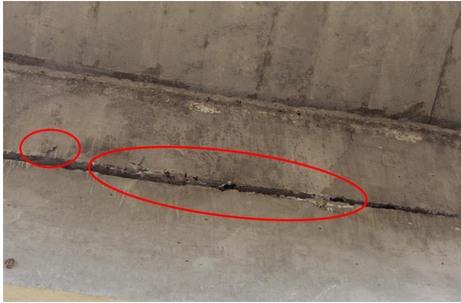
Figura 15 - Danos na transversina.
