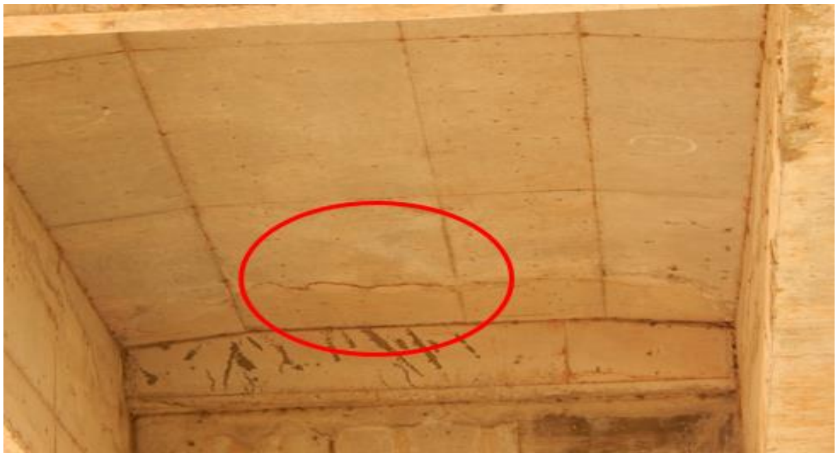
Figura 18 - Escamação do concreto no primeiro vão
