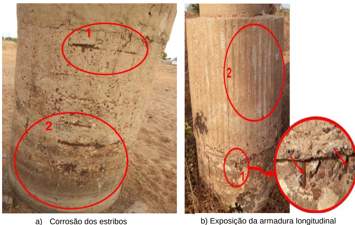
Figura 28 - Patologias observadas nos blocos de fundação
