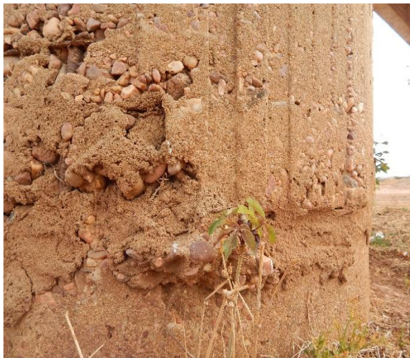
a) Ninho de concretagem com exposição da armadura no bloco de fundação
