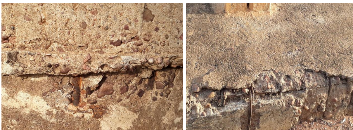
a) Corrosão e deslocamento no bloco de fundação b) Corrosão e deslocamento no guarda-rodas
