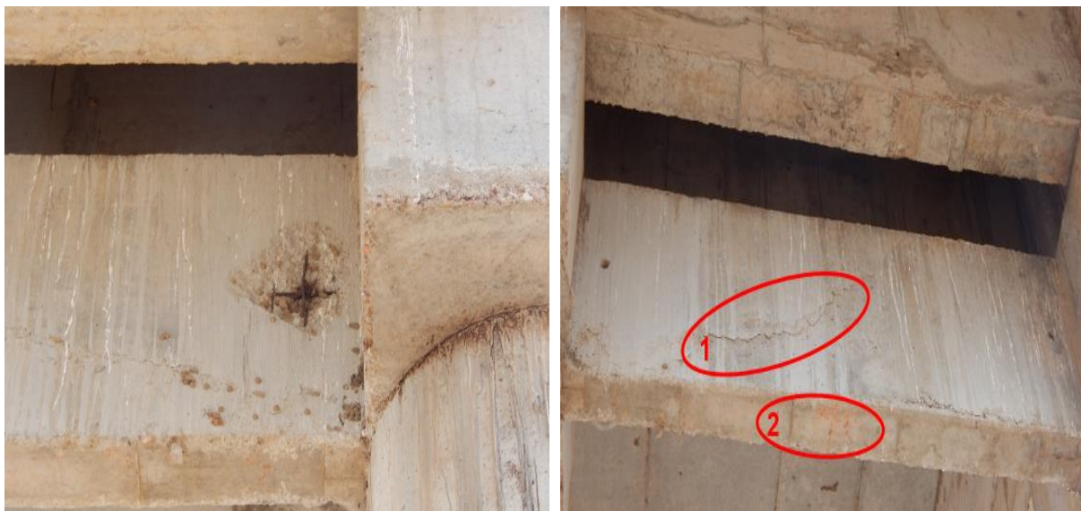
a) Desagregação junto com exposição da armadura
