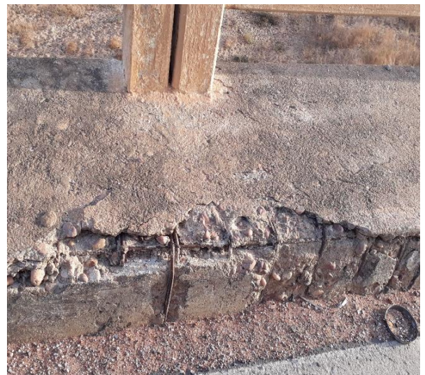
b) Deslocamento e armadura exposta
