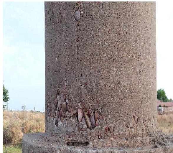
b) Ninho de concretagem no pilar
