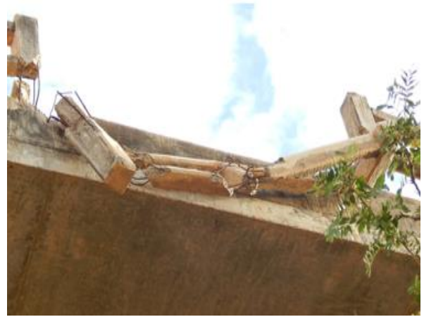
b) Guarda-corpo suspenso para fora da ponte
