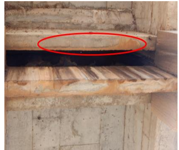
b) Manchas de corrosão
