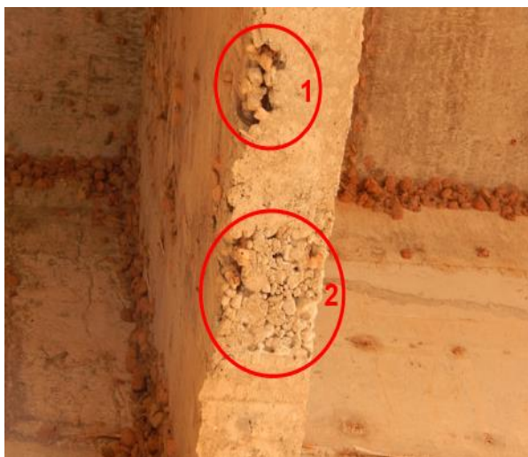
a) Ninhos de concretagem e armadura exposta
