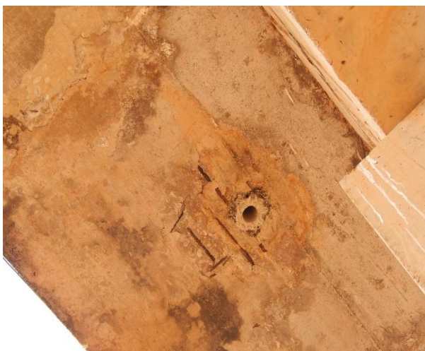
c) Deslocamento e corrosão
