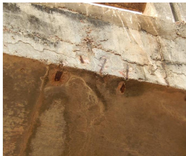
d) Armadura exposta, cobrimento insuficiente
