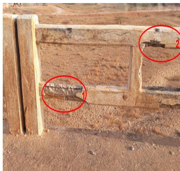
b) Corrosão da armadura e fissuras de corrosão
