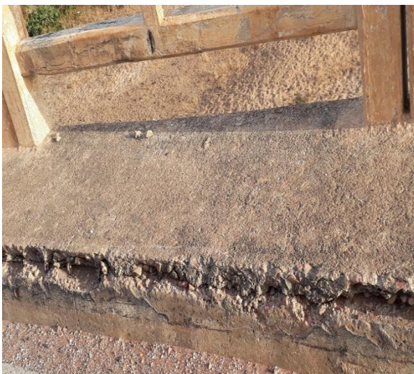
a) Desgaste do concreto
