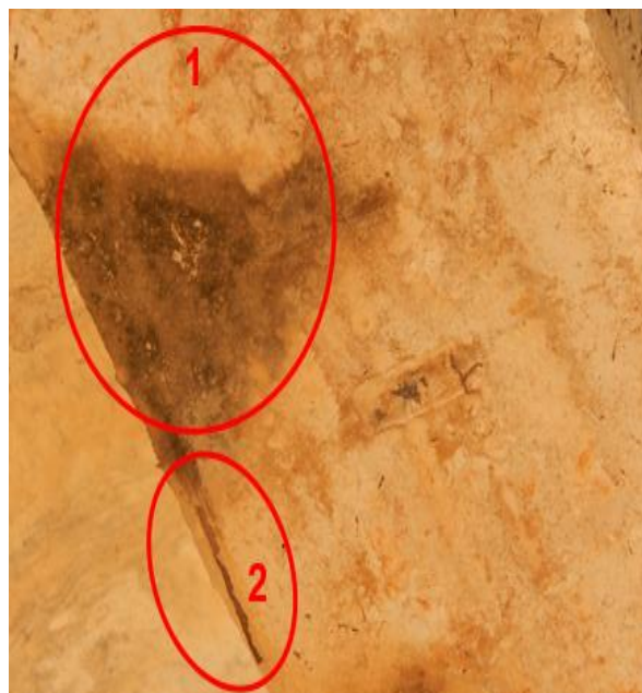
b) Presença de mofo e deslocamento
