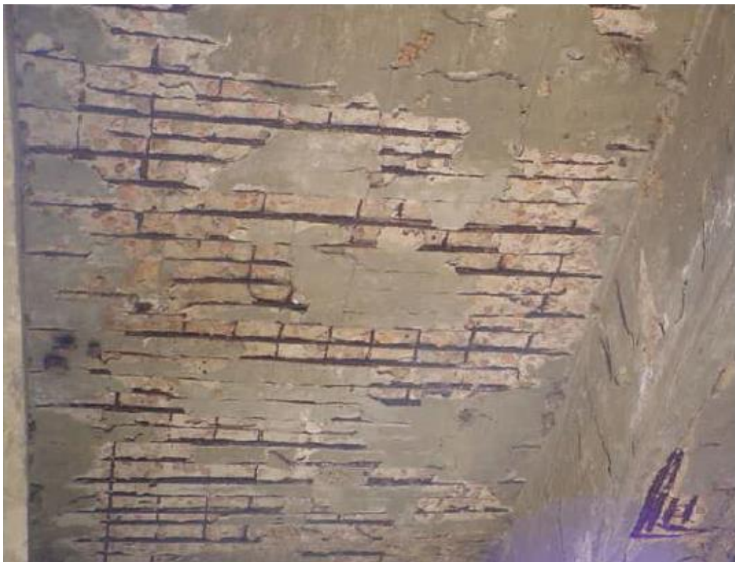
Figura 8 - Laje com sinais de corrosão da armadura e deslocamento do concreto
