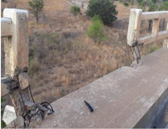
a) Guarda-corpo destruído
