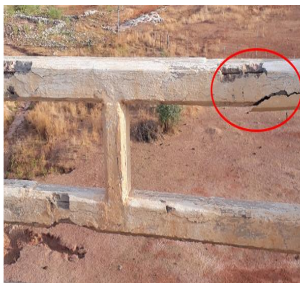
a) Deslocamento e armadura exposta
