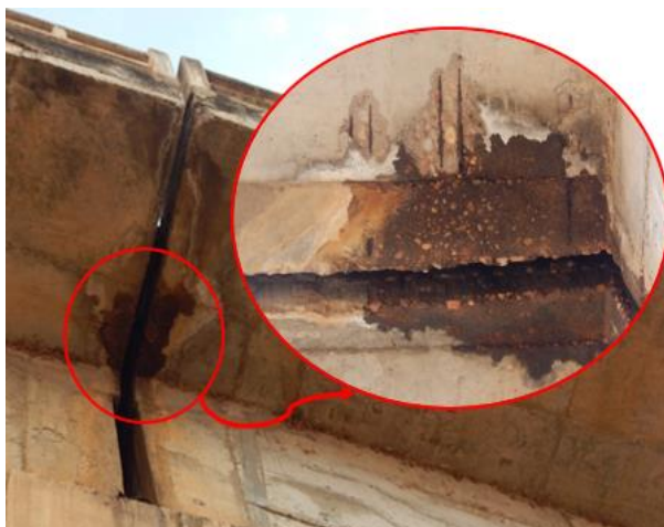
a) Manchas de umidade, corrosão, eflorescência
