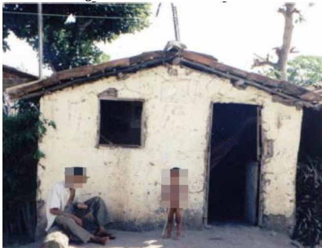
Figura 2.16 - Casa mal acabada
