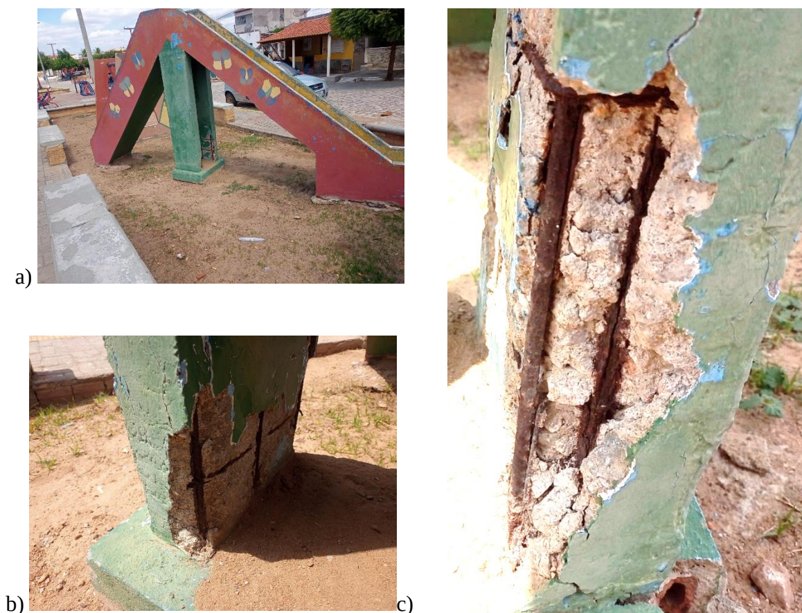
Figura 9: Caso de corrosão encontrado em estrutura de brinquedo estilo “escorregador”.
