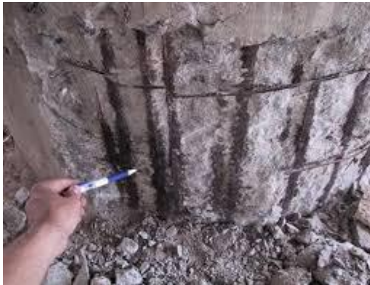
Figura 3: Exemplos de casos de corrosão em concreto.
