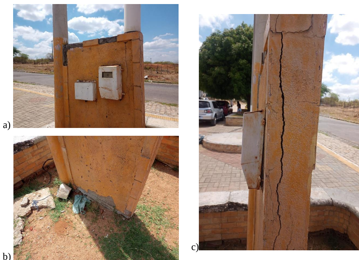
Figura 10: Caso de fissuras encontrado em estrutura de medidor de eletricidade.
