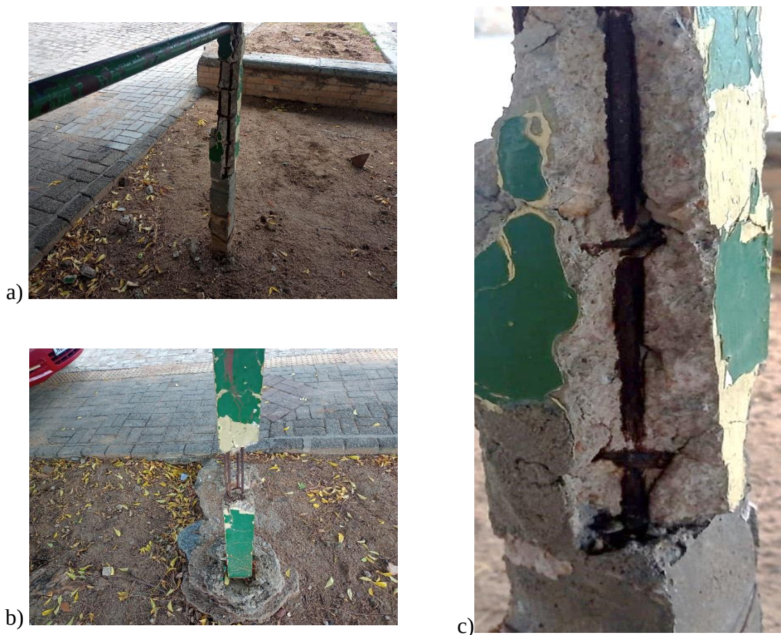
Figura 8: Caso de corrosão encontrado em estrutura de estilo “barras de ginástica”.
