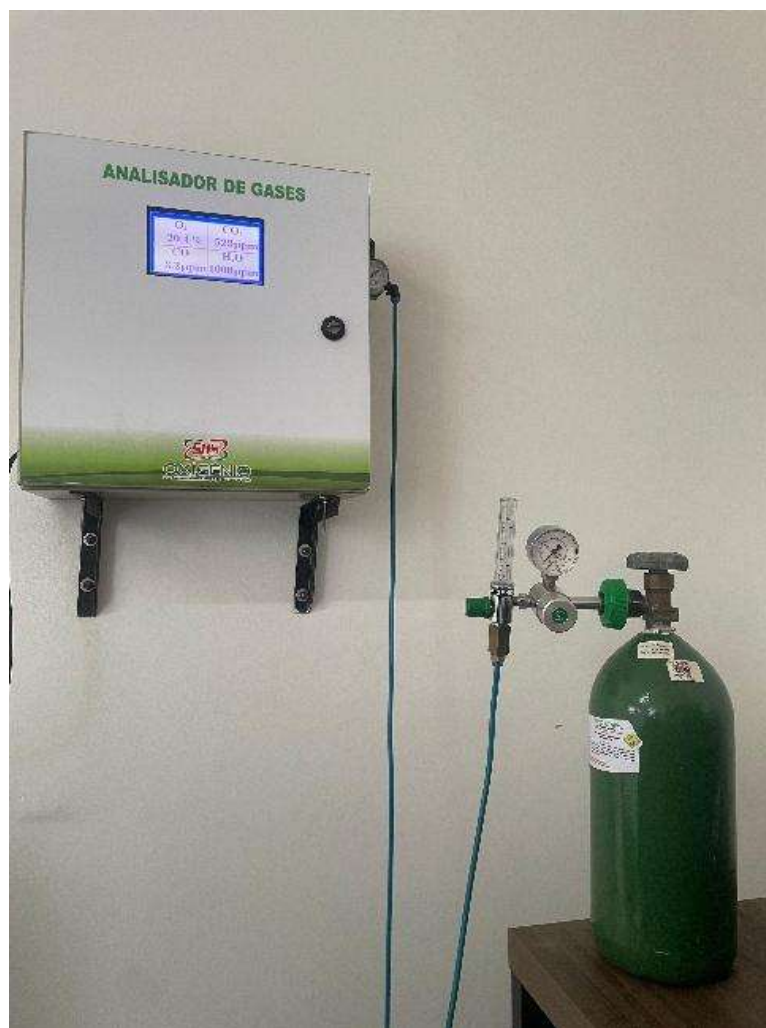
Figura 18: Analisador de gases paramagnético
